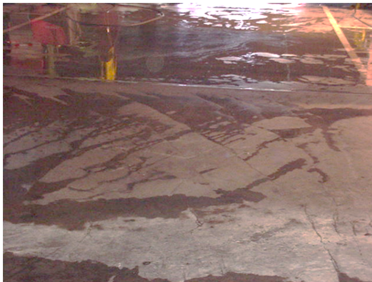
Figura 20. Fisuración concéntrica con el foco de la explosión en forjado reticular (Aparcamiento Pza. Colón, Madrid, 2001).
