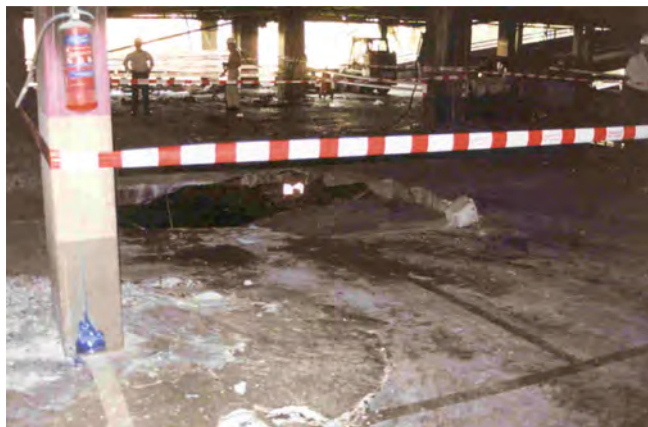
Cara superior. fisuración por punzonamiento.
