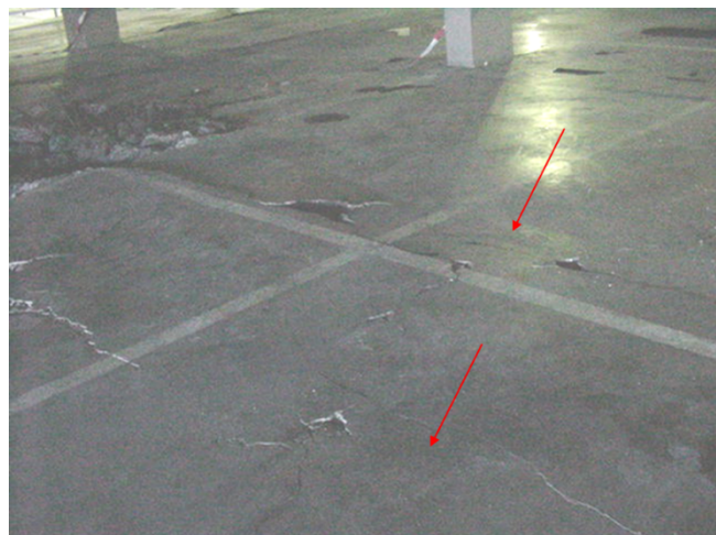
Figura 13. Daños en cara superior de forjado reticular en zonas centrales de vano, en techo sobre el foco de la explosión (efecto de la "inversión" de momentos flectores) (Aparcamiento P2 Aeropuerto Barajas, 2001).
