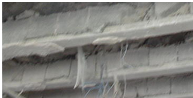
Figura 8. Fallo por rasante en un forjado unidireccional con vigueta semirresistente "en celosía" (Centro de Menores de Zumárraga, Guipúzcoa, 2001).
