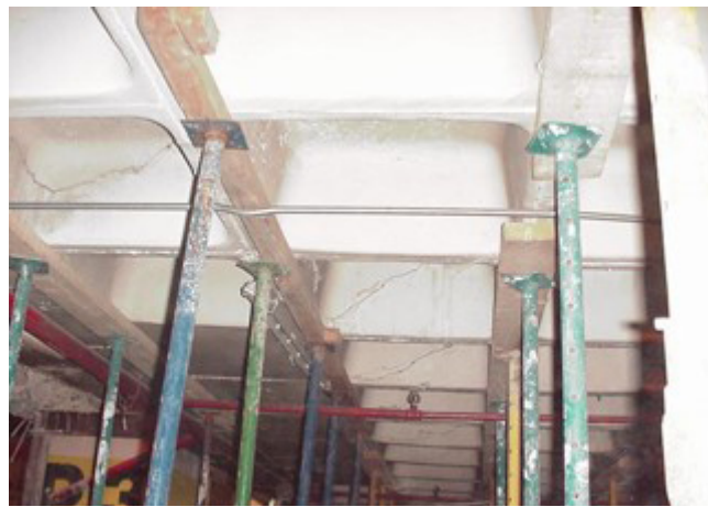
Figura 26. Centro Comercial en Zaragoza (2002). Recuadro de forjado adyacente a muro de sótano afectado, aun estando alejado del foco.
