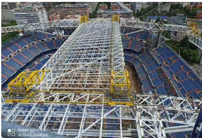
Figura 46. Desplazamiento paño del este.
