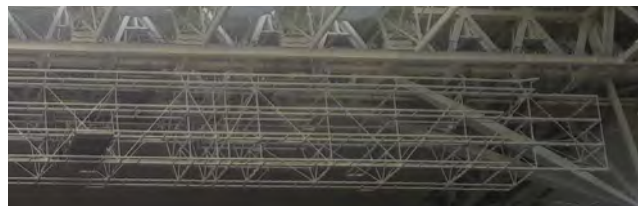
Figura 10. Estructura de laterales rodeando a los puntales de apoyo de la cercha de rodadura.
