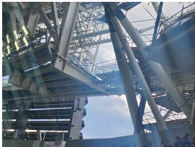
Figura 53. Skywalk. Posición de forjado basculante. Montaje parcial en el vano de junta.
