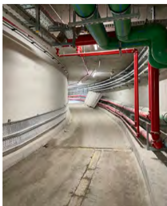
Figura 14. Imagen de la galería en proceso avanzado de construcción. Imagen procedente de visitas a obra equipo arquitectura.
