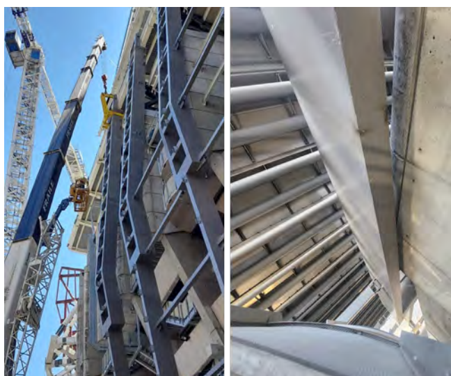
Figura 9. Izquierda: Izado de costillas “diapasón”. Derecha: Costilla diapasón abrazando costilla de hormigón existente.
