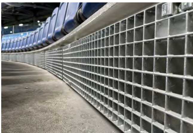
Figura 36. Imagen de tabicas de rejilla metálica en zona de grada baja para toma de aire. Imagen tomada por equipo de diseño en visita a obra.
