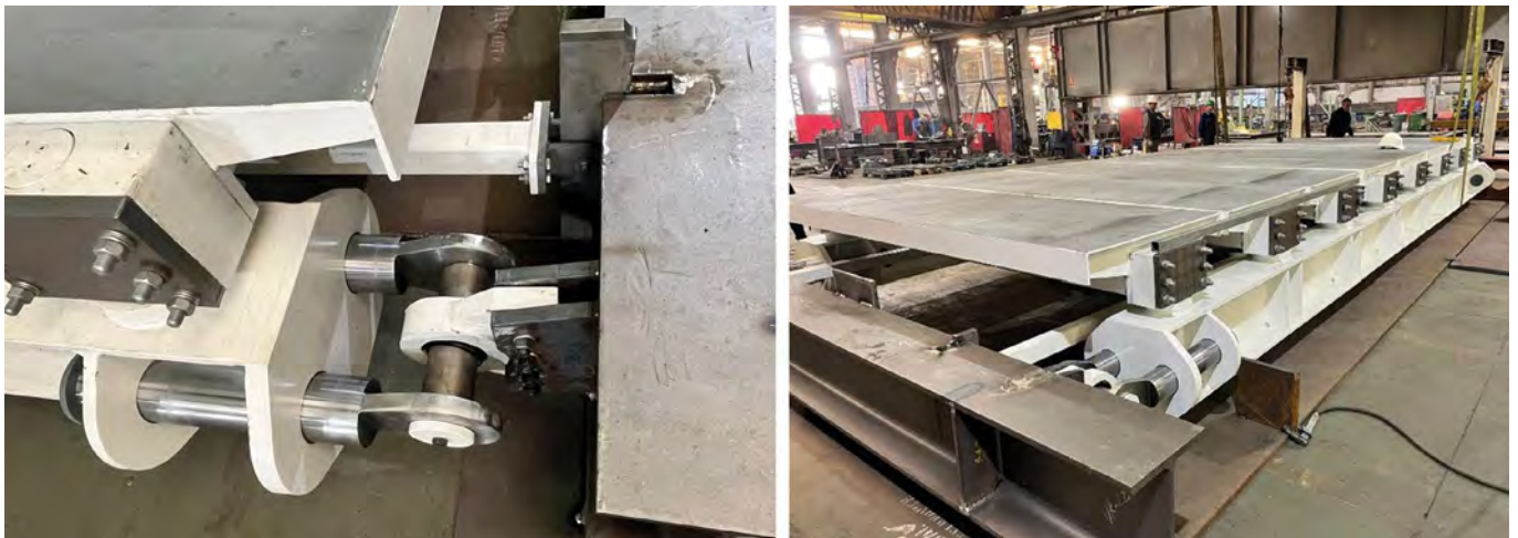
Figura 56. Prueba de funcionamiento puentes basculantes.
