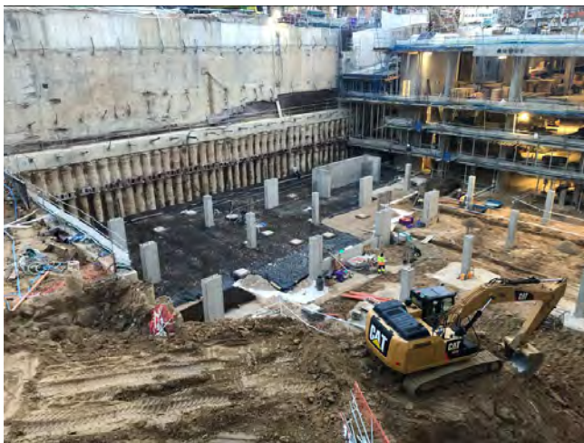
Figura 3. Sótanos del 5 al 1 ejecutados en lado sur y ejecución del resto de zapatas y pilares del sótano 5 en lado norte.
