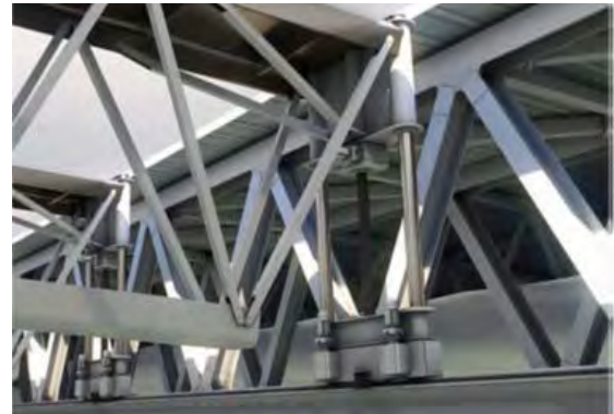
Figura 8. Vista general sistema de elevación.
