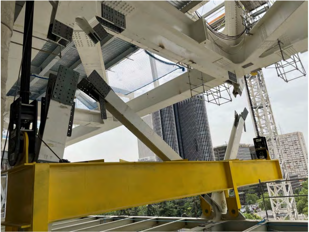
Figura 31. Conexión cuelgues verticales viga museo pendientes de realizar.
