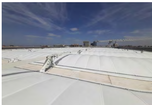
Figura 44. Prototipo de cojín (arriba) – Cojines instalados (abajo).
