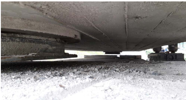
Figura 23. Aparatos de apoyo originales colgando del tablero.
