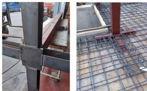
Figura 4. Conectores del tipo cruceta, soldados a columna formada por 2 UPNs en cajón cerrado. Capitel empleado en la resolución de una losa maciza en edificación.
