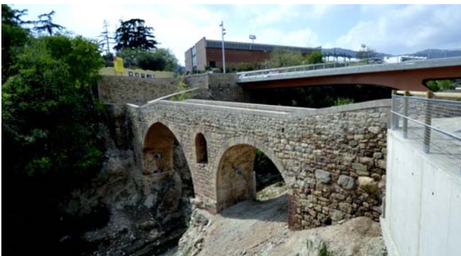
Antiguo Puente de "Les Cremades" en Caldes de Montbui restaurado y el nuevo puente en segundo plano
