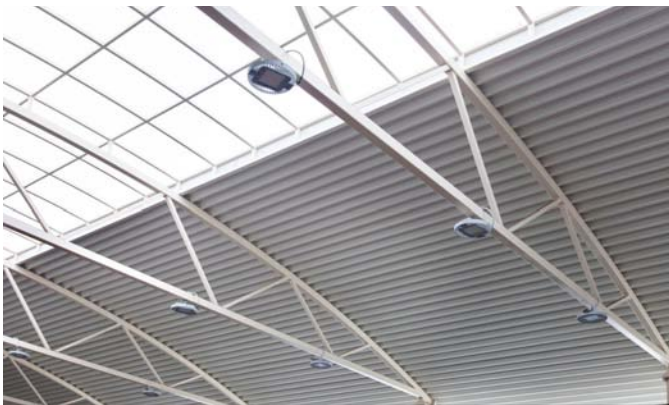
Vista interior de la nave, con celosías metálicas con perfiles tubulares y chapa grecada
