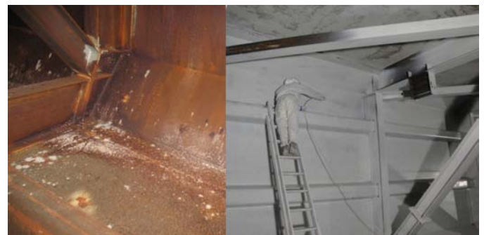
Antes y durante la aplicación de una capa de pintura en interior del cajón metálico
