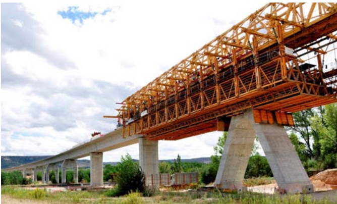
Lanzamiento de viaducto con autocimbra superior. Paso por pila en A (punto fijo del tablero)
