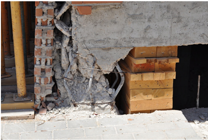
Fallo de columna corta
