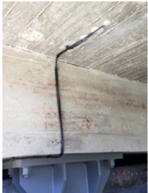
Sensores instalados en el tablero
