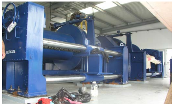
Vista general del sistema de tiro
