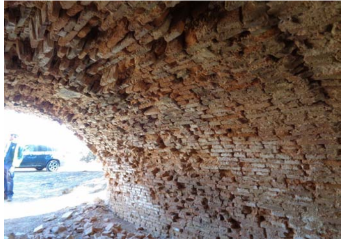
Pérdida de piezas de ladrillo en zonas extensas de la bóveda
