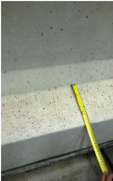
Defecto superficial en viga prefabricada
