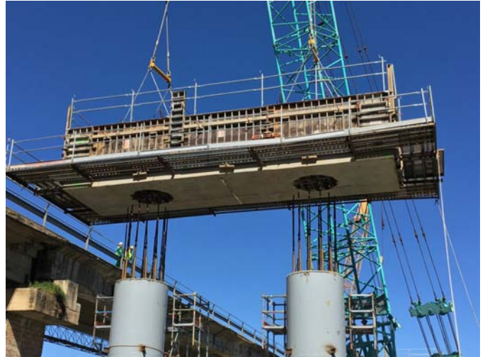
Descenso de prelosa de dintel y pretensado de cabeza de pilas en espera
