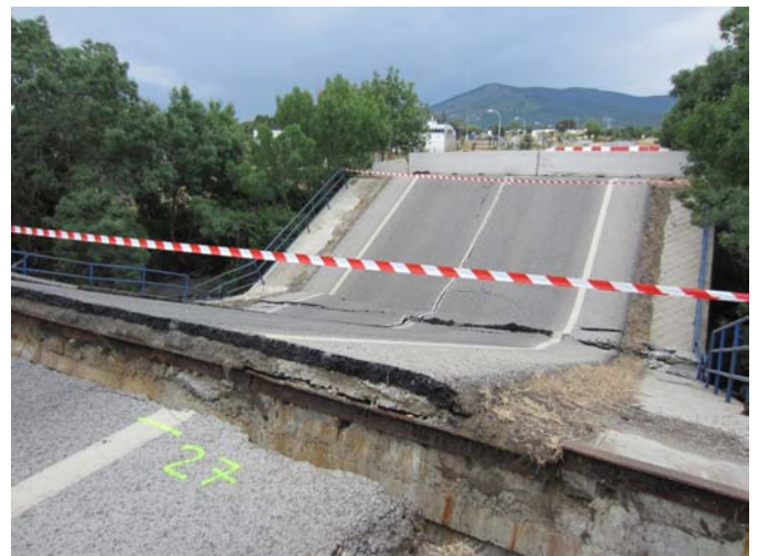
Figura 1. Vista del puente colapsado el 29 de mayo de 2015
