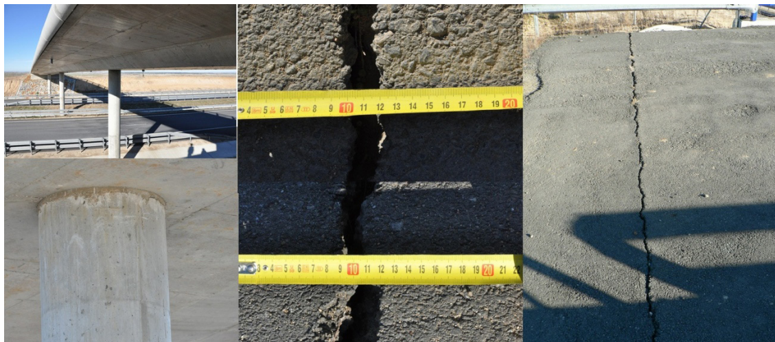
Estado del puente luego de cuatro años de servicio
