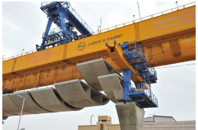
Izado de segmentos en vanos isostáticos. Estado previo al ensamblaje y tesado del vano
