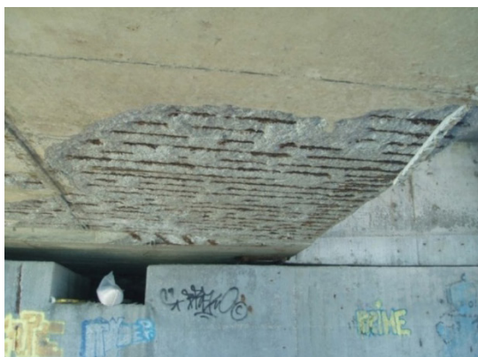
Armadura corroída en la parte inferior del tablero cajón
