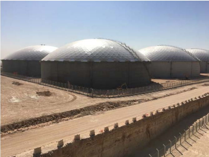
Depósitos metálicos de Riyadh con una capacidad de 166.666 m 3 /tanque
