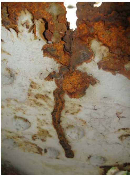
Fisura en platabanda
