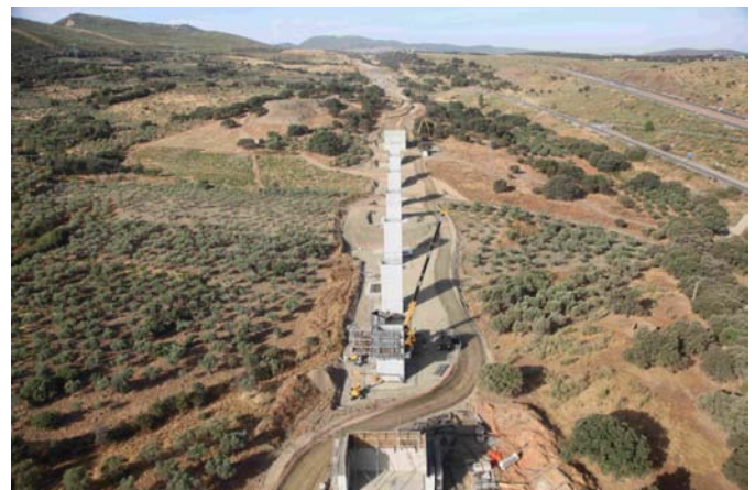
Vista aérea del viaducto sobre el Arroyo Viña de los Frailes en ejecución
