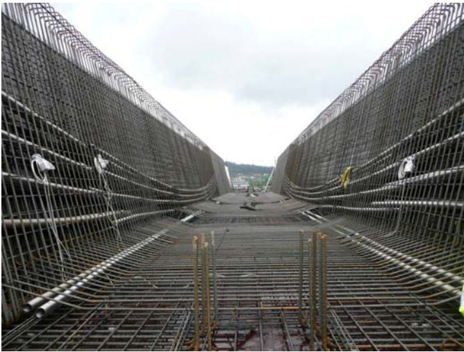
Instrumentación del tablero del viaducto de O Marco, Eje Atlánti
