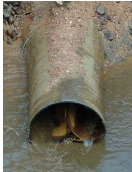
Colapso de una tubería de PRFV
