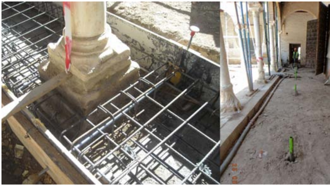
Refuerzo de cimentación con barras Freyssibar e inyecciones armadas para consolidación del terreno
