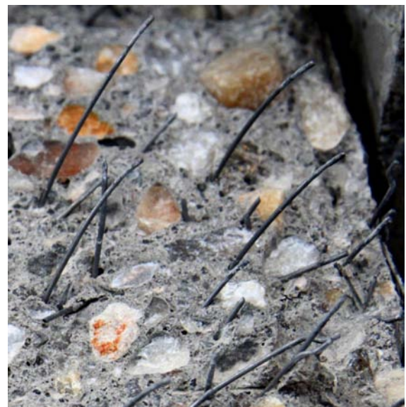
Fibras con anclaje arrancadas y rotas en la superficie de la fisura
