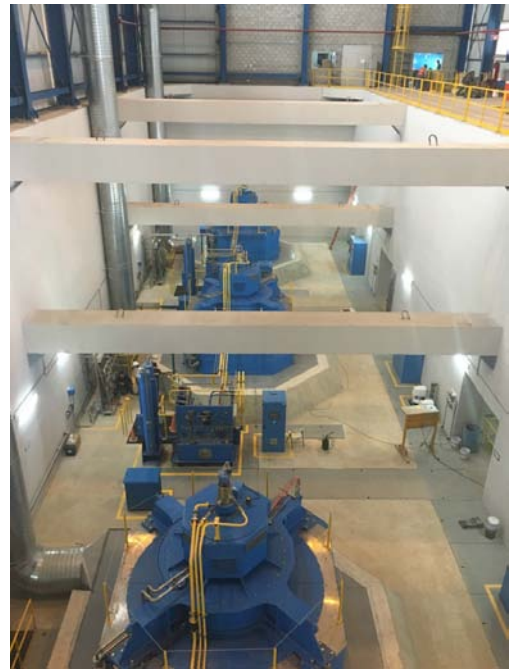
Situación final. Interior de la casa de máquinas
