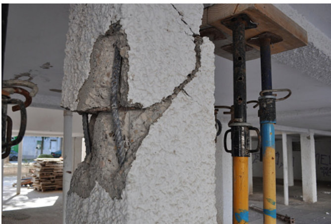
Daño a cortante de una columna
