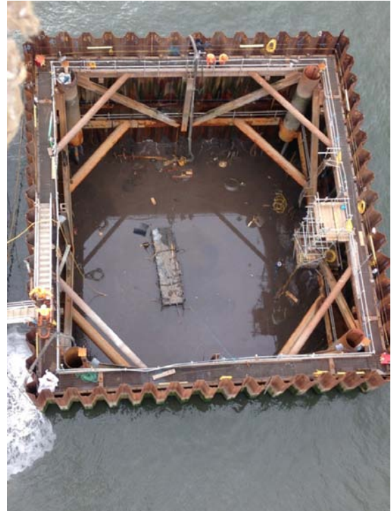
Recinto con pozos de achique
