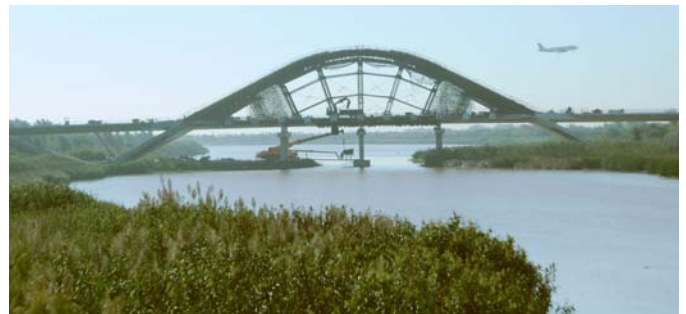
Cimbra del arco y pilas provisionales en el puente Nelson Mandela sobre el Río Llobregat (2014)
