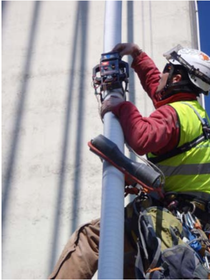
Detección de oquedades mediante inspección con sonda capacitiva
