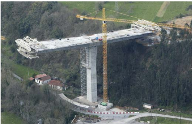
Detalle de construcción mediante carros de avance de voladizos sucesivos en Pila 6
