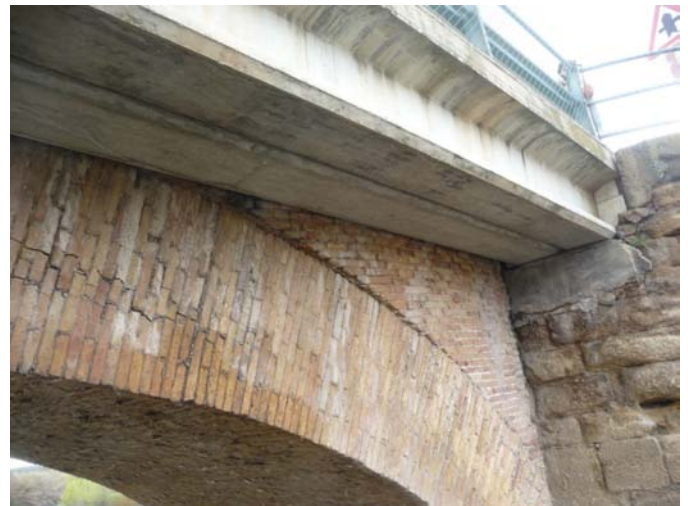
Figura 1. Pareja de vigas dispuestas para ensanchar la plataforma de un puente de ladrillo
