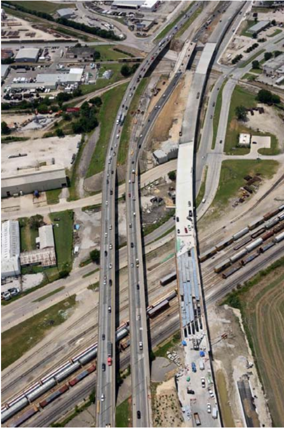
Puente 205 en ejecución para el cruce de la GP35-NB sobre Hodge Yard
