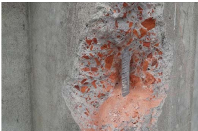
Cata estructural mostrando el hormigón con árido a base de trozos de ladrillo
