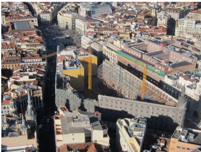
Figura 1. Vista área del conjunto de la manzana tras la demolición de la estructura no protegida
