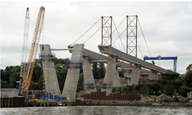
Torres de atirantamiento
