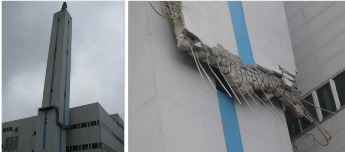
Fallo de una chimenea en Japón, debido a una insuficiente longitud de solapo
