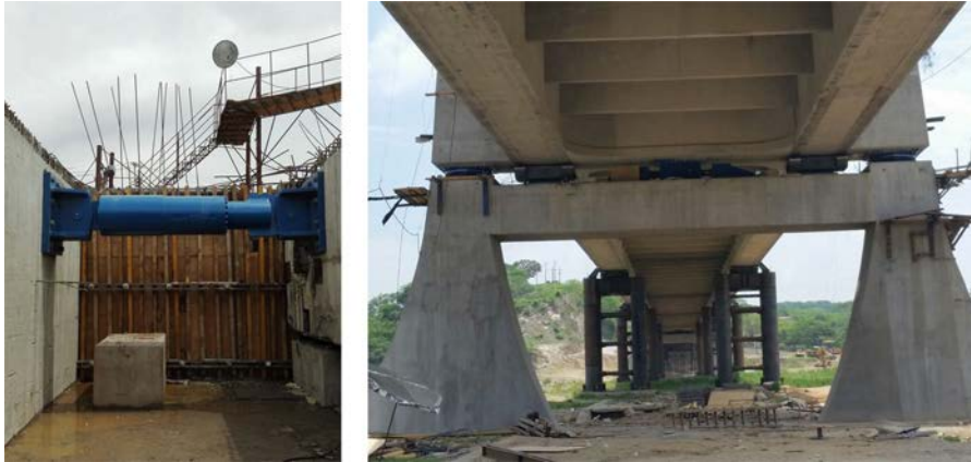
Figura 4. Aisladores sísmicos longitudinales en estribo I y transversales bajo una de las torres. Bajo el tablero se ven los apoyos definitivos, los balancines para el empuje y el amortiguador transversal.
