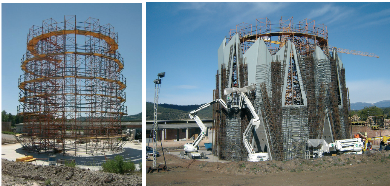
Figura 26. a) Estructura auxiliar de soporte y b) colocación del armado de los muros del ábside. Fuente: ATESF Figure 26. a) Ancillary support structure and b) placement of the reinforcement for the apse walls. Source: ATESF
