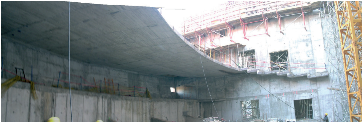
Figura 12. Vista inferior del sistema estructural que conforma el anfiteatro Figure 12. Amphitheatre structure lower view.
