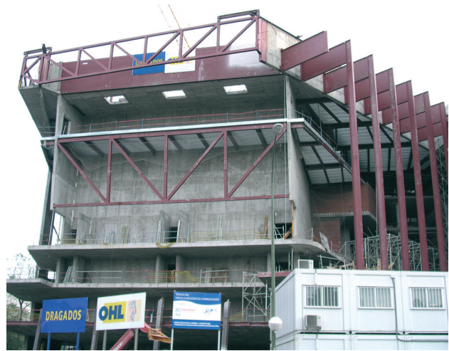
Figura 29. Estructura metálica de fachada colgada desde ménsulas en el Teatro Configurable y celosías frontales de cuelgue de perfiles de fachada.
