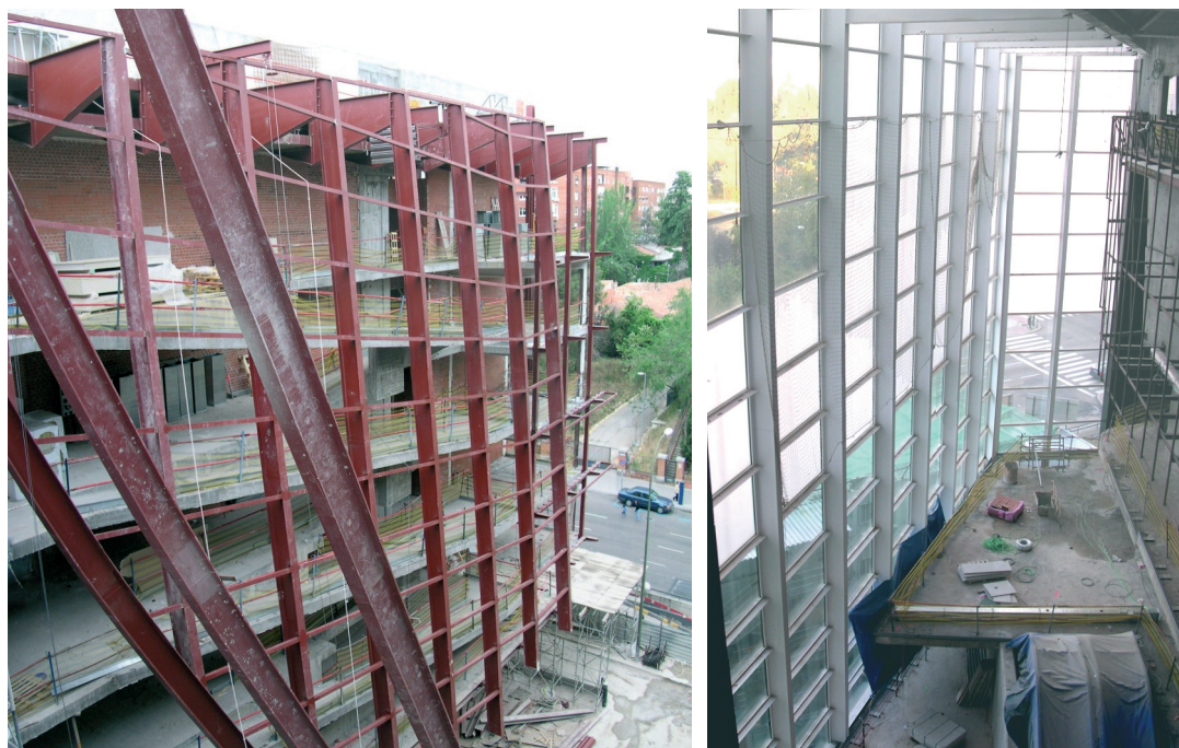
Figura 28. Estructura metálica de fachada colgada desde ménsulas en el espacio entre el Centro Coreográfico y el Teatro Principal. Figure 28. Upper façades steel structure hung from cantilevers between the Choreographic Centre and the Main Theatre.
