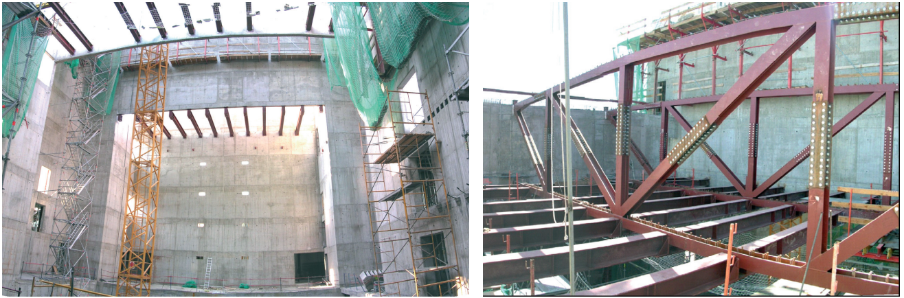
Figura 19. Interior de la caja escénica del Teatro Configurable. Estructuras mixtas. Figure 19. Composite structures inside the Configurable Theatre stage house.
