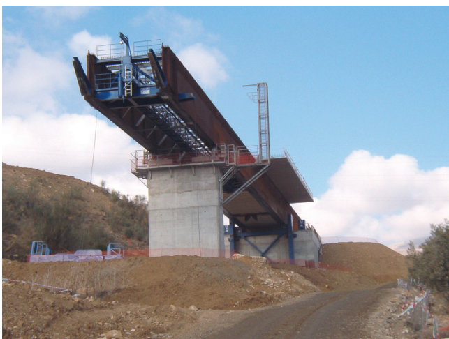
Fig. 19. Vista frontal de los patines de empuje. Fig. 19. Front view of the launching skids
