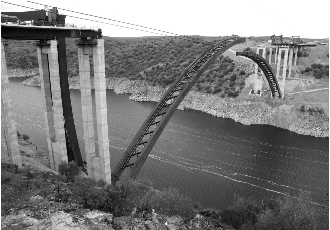
Figura 1. Situación constructiva cuando se produjo el primer fenómeno de resonancia.
