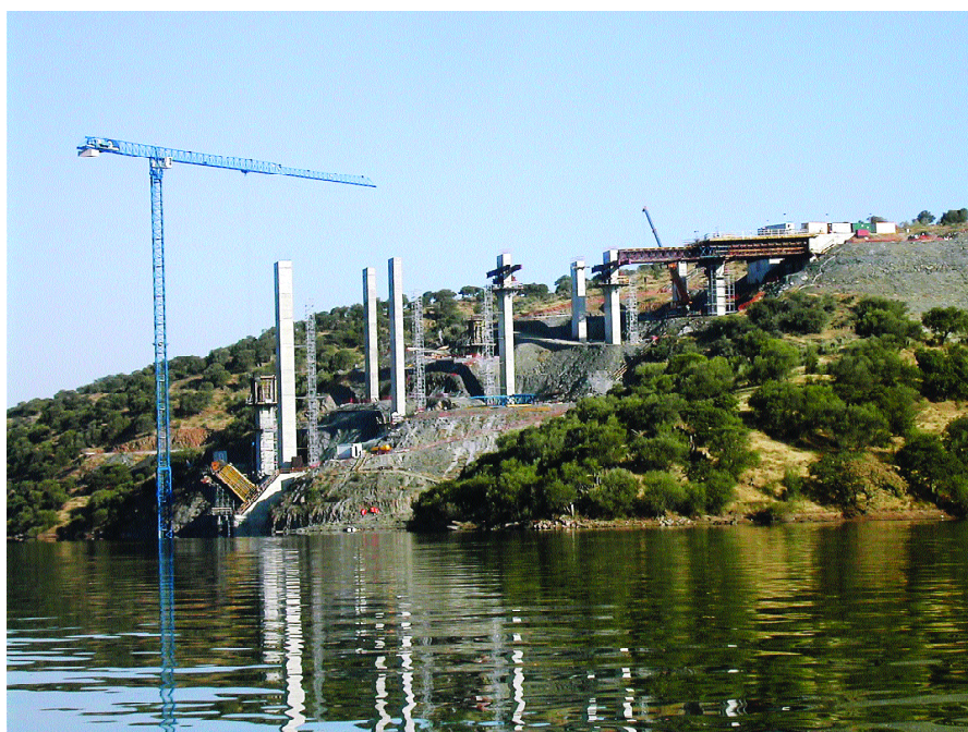
Fig.5. Máximo nivel del embalse, en construcción. Fig.5. Maximum level of the reservoir, under construction.
