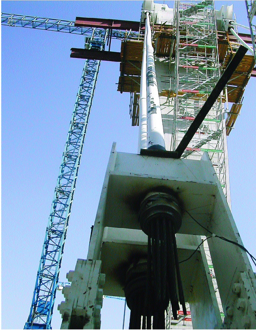
Fig.40. Detalle de tesado de los cables de retenida. Fig.40. Detail of retaining cable tensioning.
