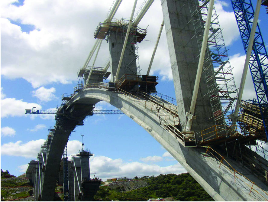
Fig. 24. Viaducto de Almonte. Proceso constructivo desarrollado para ACCIONA Infraestructuras. Fig. 24. Almonte Viaduct. Construction process developed by ACCIONA Infraestructuras.
