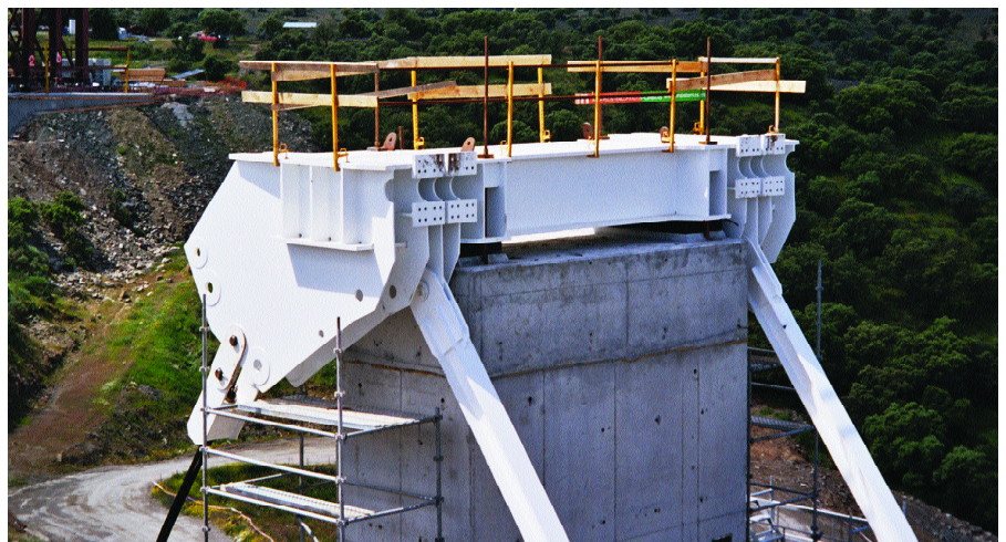
Fig.41. Detalle de nudo en pila sobre el arco. Fig.41. Detail of a pier node on the arch.
