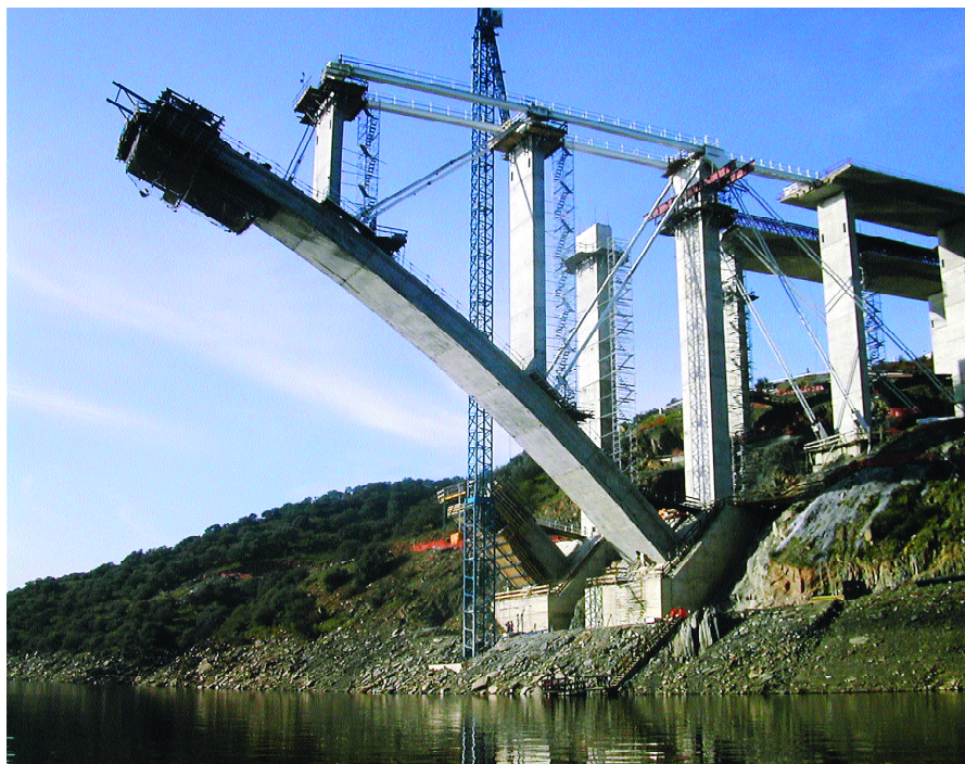
Fig.22. Viaducto de Almonte. Proceso constructivo por triangulación. Fig.22. Almonte Viaduct. Triangulation construction process.
