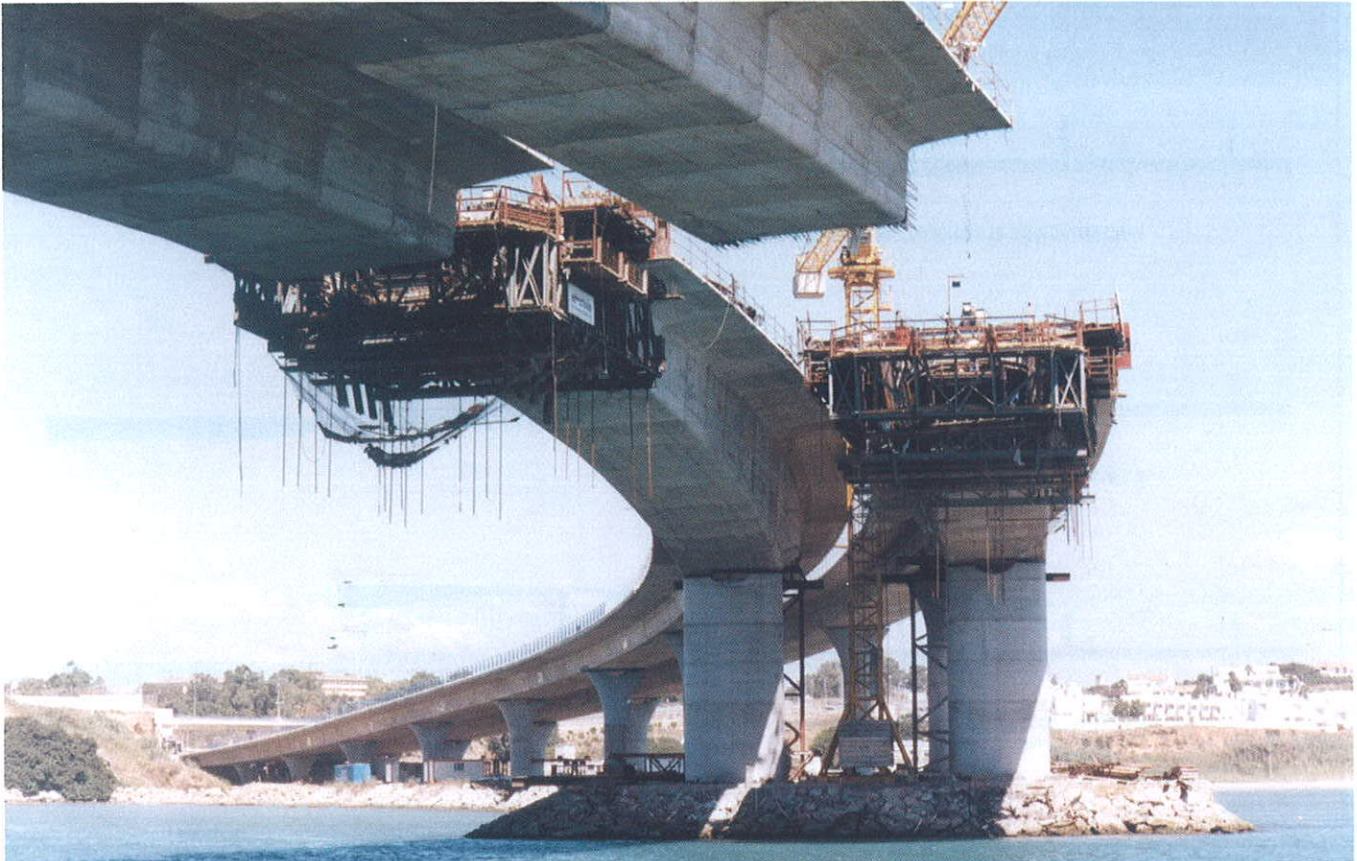
Foto 6. Construcción del vano central mediante voladizos sucesivos. Photo 6. Construction of the main span by balanced cantilevers.
