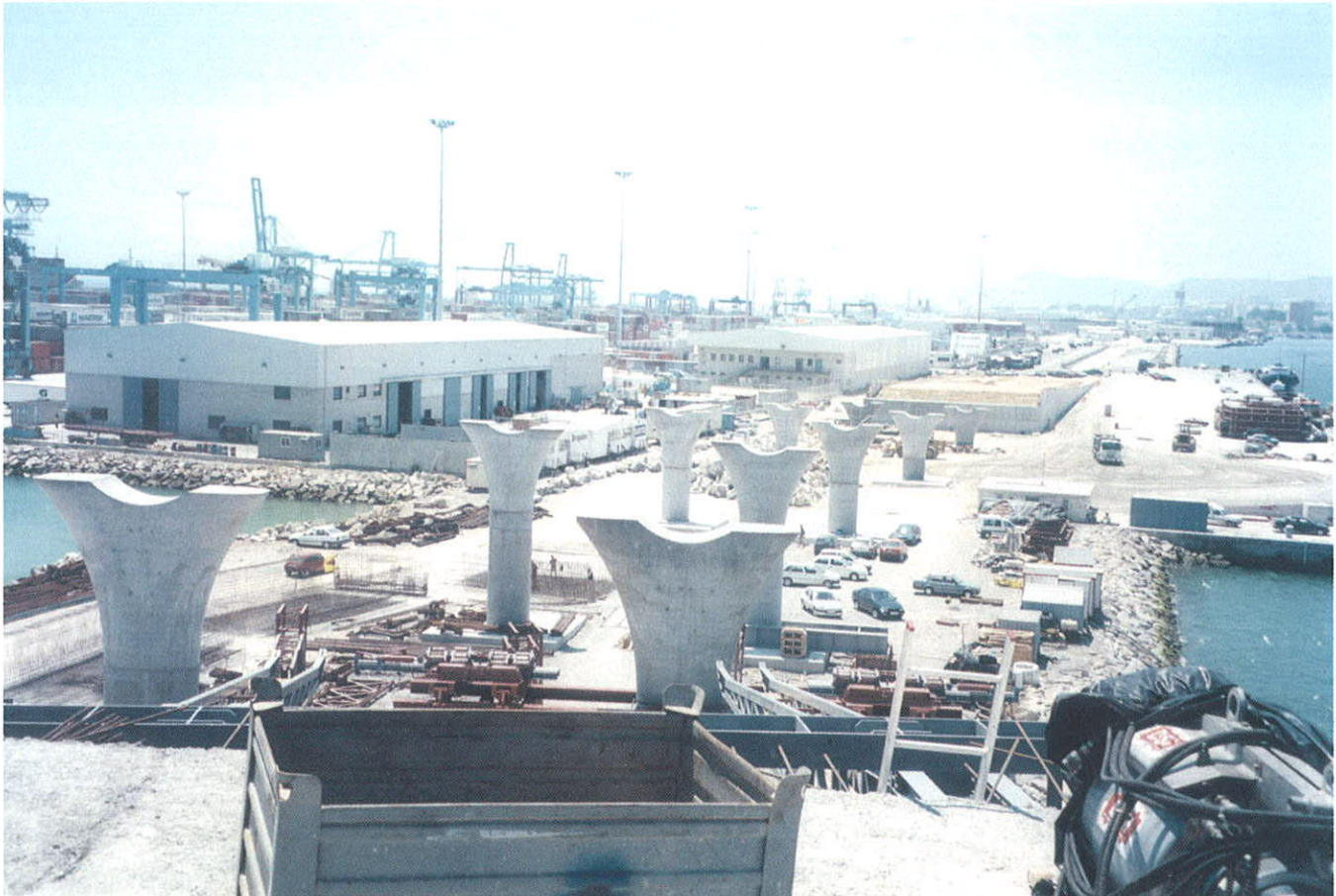
Foto 7. Vista general del comienzo de la construcción del puente en la ampliación del muelle del Navío. Photo 7. View of the construction process in the enlargement of the Navío quay.
