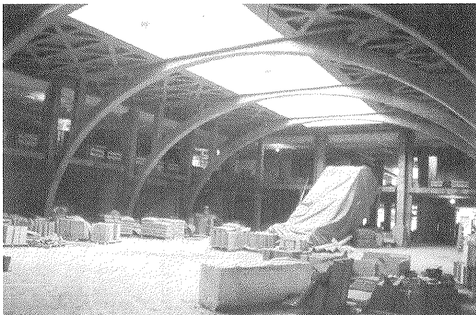
Figura 4. Multicentro de Alicante. (Arq. F. de Andrés + CYPE Ingenieros Estudios y Proyectos, S.A.)
