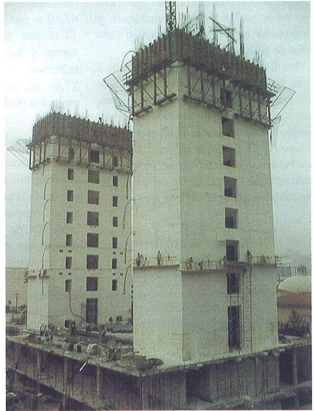
Inicio de la construcción de los núcleos. Beginning construction of concrete cores.
