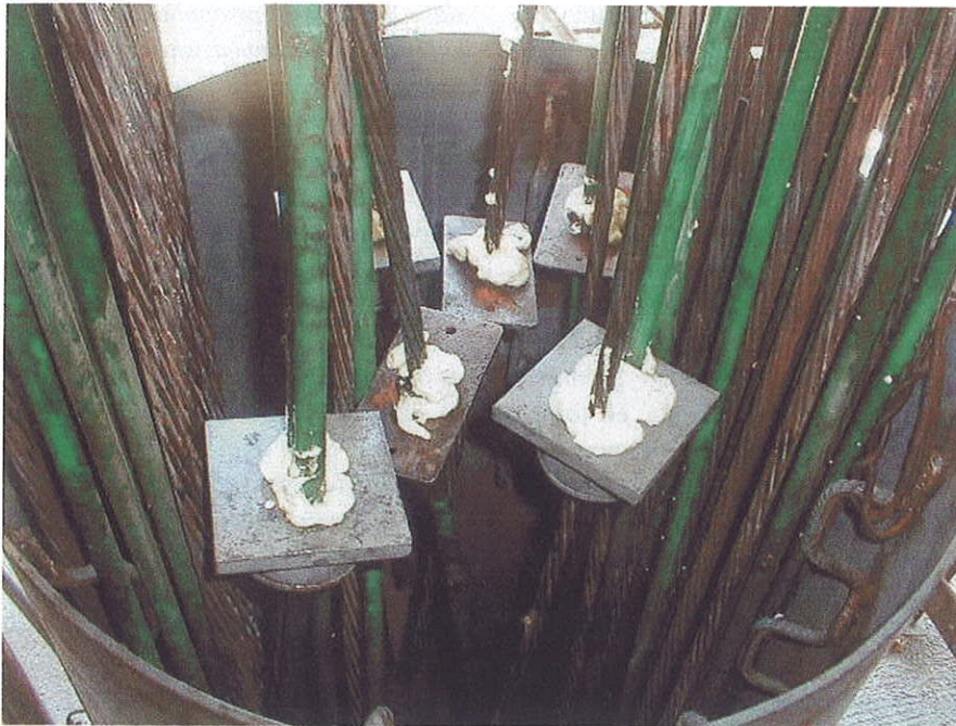
Figura 9. Cordones que constituyen un tirante. Pueden distinguirse los cordones no adherentes (envueltos en vaina, de color verde) de los adherentes (sin protección inicial). La imagen corresponde en una zona donde existe forjado, en que se han dispuesto 6 anclajes pasivos.
