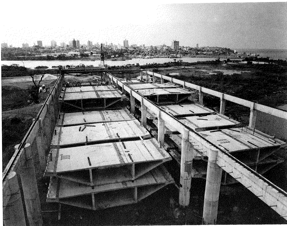
Depósito de dovelas prefabricadas.
