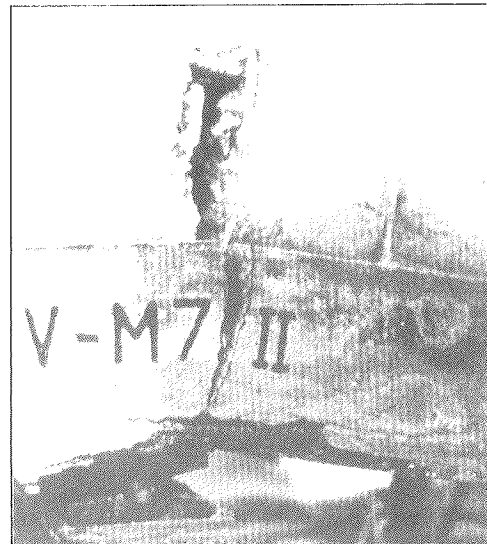
Foto 41. Fallo en el bloque comprimido.
