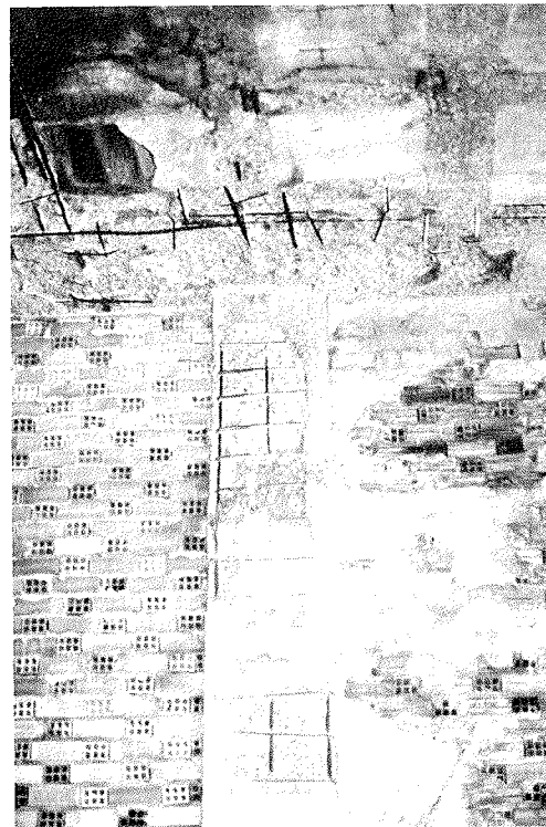
Foto 5. Pérdida del recubrimiento del hormigón en elementos a compresión y flexión.
