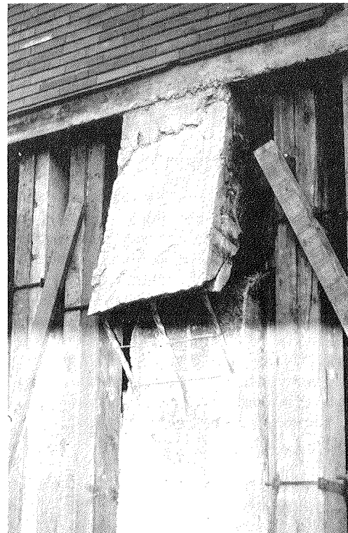
Foto 7. Daños en las armaduras de soportes.
