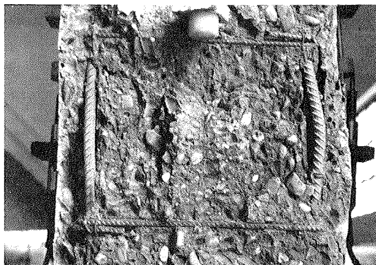
Foto 4. Detalle de la rotura de un pilar.
