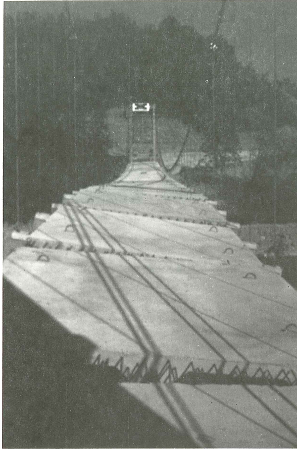
Fig. 16. Colocación de tirantes. Deformación del tablero al colocar el tirante de uno de los cables.
