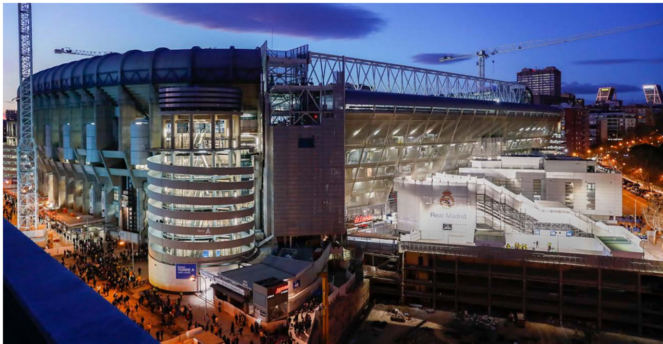
Figura 3. Escaleras provisionales de acceso y evacuación.
