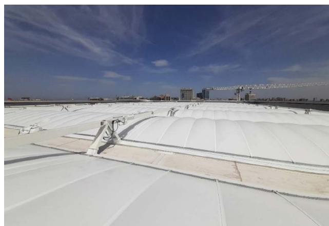
Figura 44. Prototipo de cojín (arriba) – Cojines instalados (abajo).
