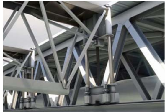
Figura 8. Vista general sistema de elevación.
