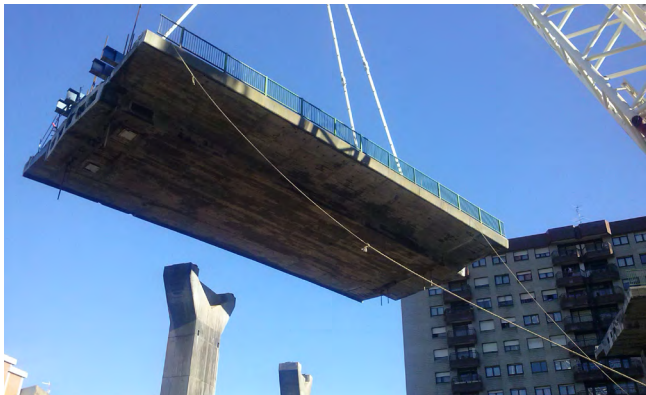
Figura 21. Desplazamiento de tramo de tablero tras su separación del resto de estructura.
