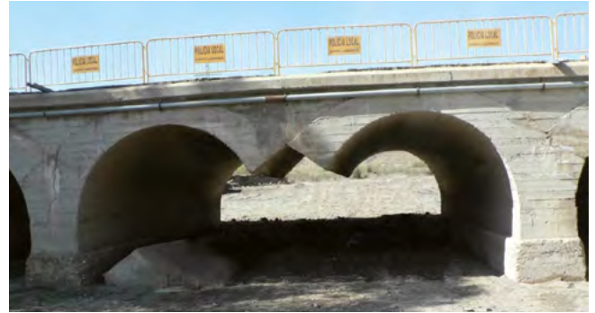
Figura 8. Puente en Puerto Lumbreras, 1 de octubre de 2012. Foto de los autores. A la izquierda se observa la pila socavada y volcada, con los arranques de las dos bóvedas acodalados precariamente entre sí.
