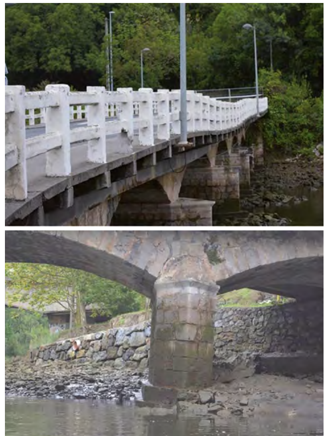
Figura 25. Descensos y giros en pila como consecuencia del deterioro progresivo de las cimentaciones profundas (pilotes) del puente de Astiñene (S. Sebastián). Fotos de los autores (2017).
