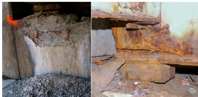
Figura 31. Deterioros en el hormigón y en el acero en una clase de exposición adversa (en este último caso con una rotura por tracción del alma debida al deterioro del hormigón bajo el aparato de apoyo) [24].
