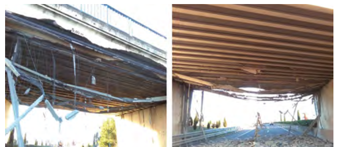
Figura 5. Impacto de un camión en Navarra en febrero de 2019. Foto de FHECOR.
