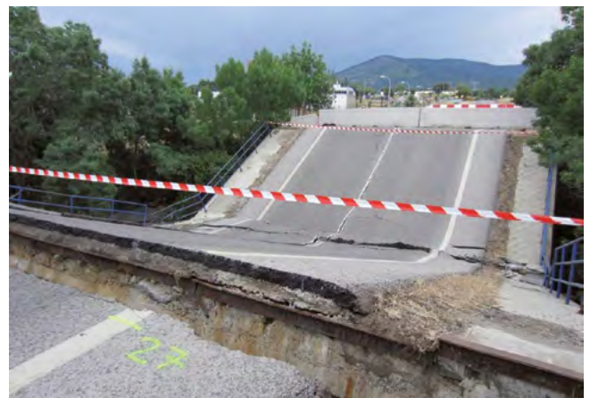
Figura 9. Ejemplo de puente con 22 cm de exceso de pavimento. Puente de la M-527 sobre el río Guadarrama (29 de mayo de 2015). Foto de los autores.
