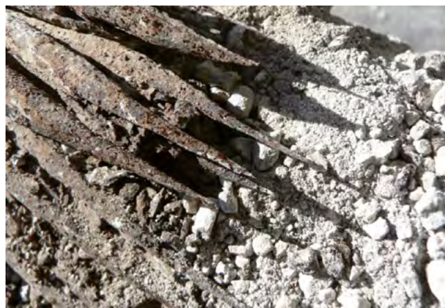
Figura 16. Tirante roto en el puente Fernando Reig en Alcoy (julio de 2016). Corrosión anódica. Foto de los autores. Se procedió a la sustitución del 100% de los tirantes.
