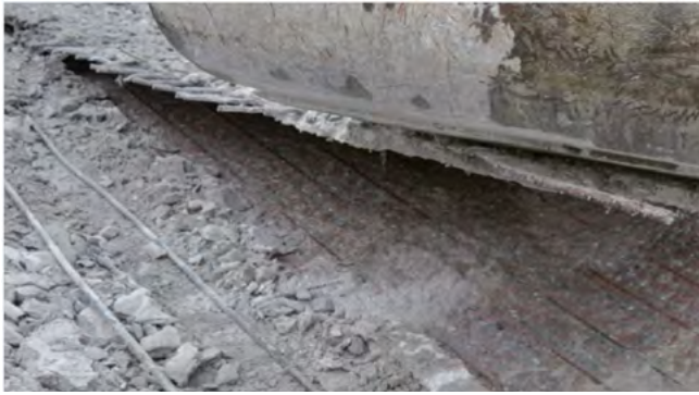
Figura 23. Recreido desconectado en la losa superior de un puente. No había armadura de conexión, por error de proyecto, pero lo peor era que la resina en que se confió, que había impregnado en el sustrato, polimerizó antes de verter el hormigón del recreido, propiciando el deslizamiento.
