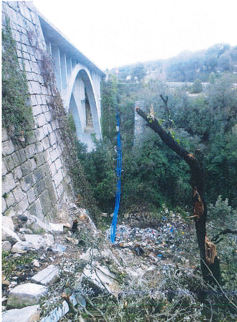
Figura 11. Colapso total de un pretil metálico dispuesto en la rehabilitación de un puente.
