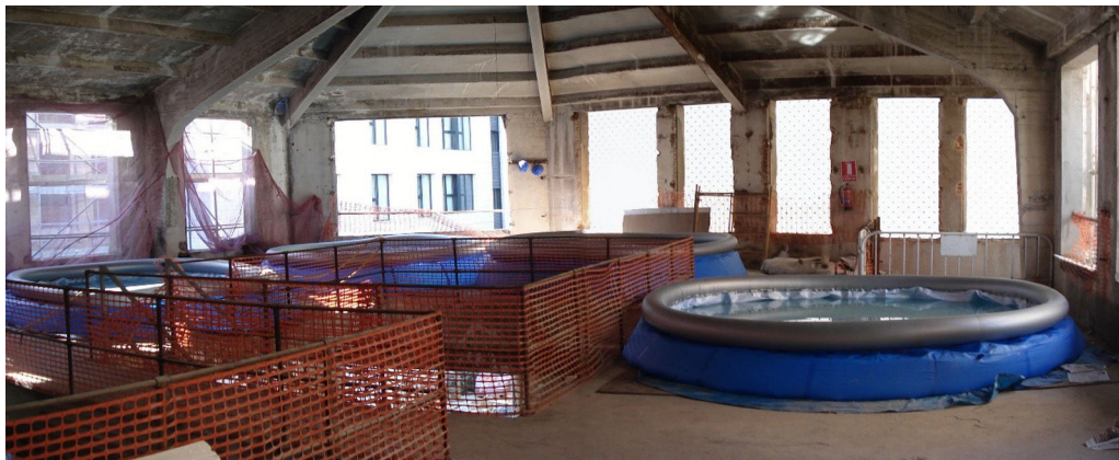
Figura 17. Vista de las bañeras de agua usadas para la prueba de carga de los forjados.
