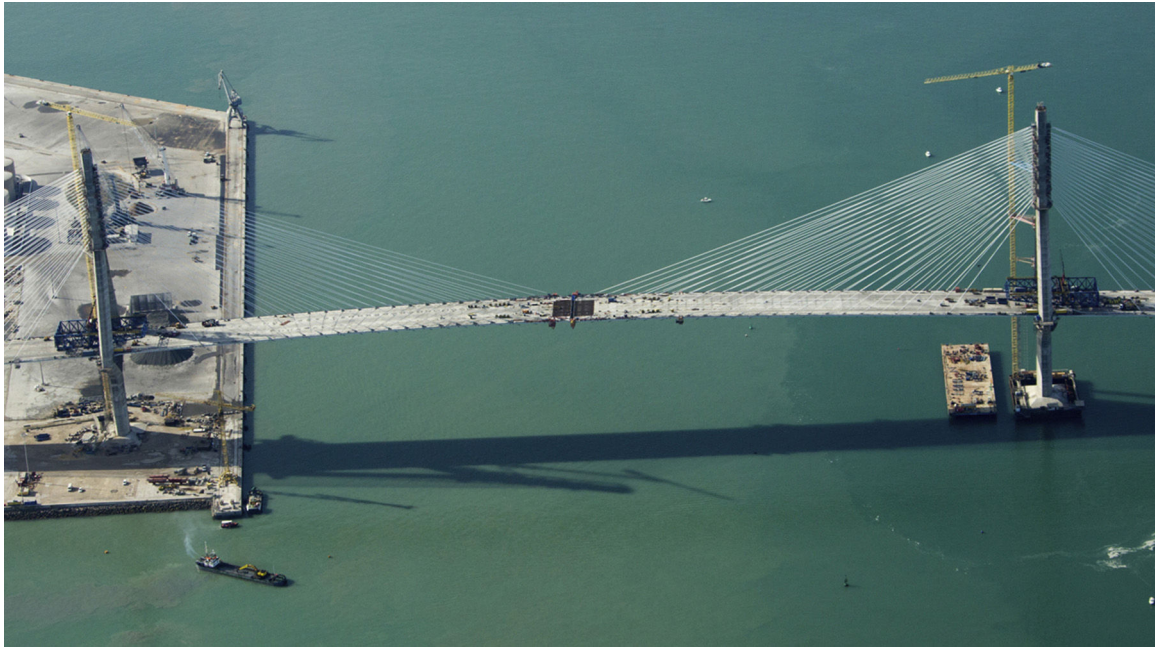
Figura 13. Situación del tablero en los momentos previos al cierre del vano central.
