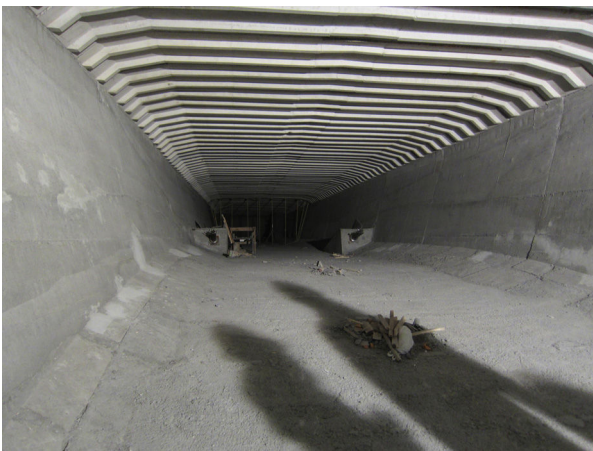
Figura 27. Vista del interior de la sección transversal con los anclajes de pretensado de positivos al fondo.
