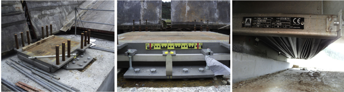
Figura 13. Vista de un apoyo, sistema de medición con regleta y protección guardapolvere.
