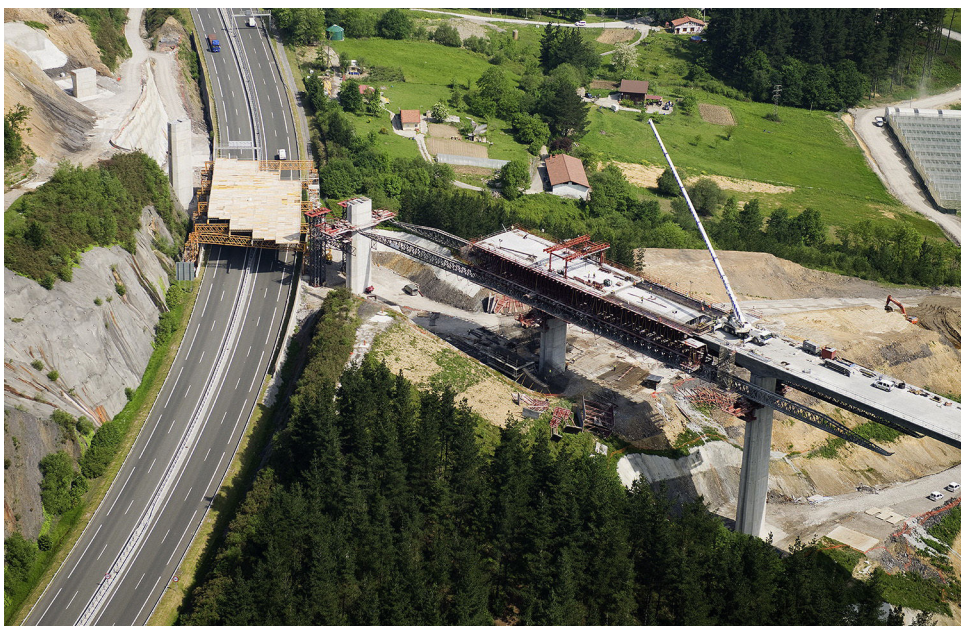
Figura 25. Vista de la zona de negativos completamente hormigonada y colocación de prelasas en el tramo de positivos sobre el que se ferrallará y hormigonará la losa posteriormente.
