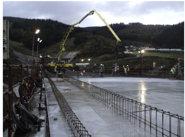
Figura 24. Vista del hormigonado de la losa superior con bomba desde el frontal de la fase previa.
