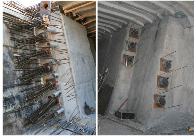
Figura 28. Anclajes de tendones de continuidad, con cruce de cables: anclajes activos en frente de fase y anclajes pasivos.
