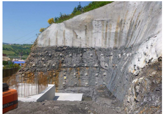
Figura 17. Excavación de la cimentación de P-10, con bulones y gunitado de las laderas.
