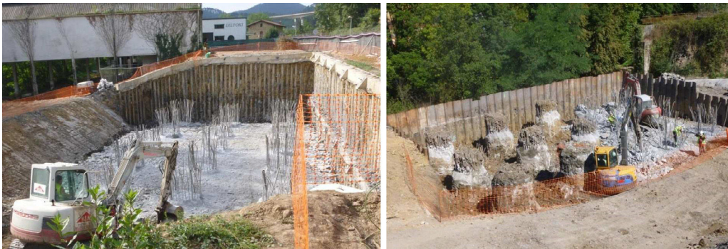
Figura 16. Pantallas de micropilotes anclados en la contención de la cimentación de la P-7 (imagen izquierda) y pantallas de tablestacas en la cimentación pilotada de P-8.
