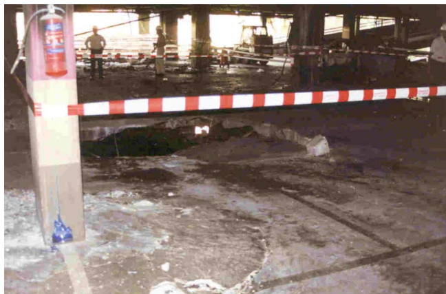
Cara superior. fisuración por punzonamiento.
