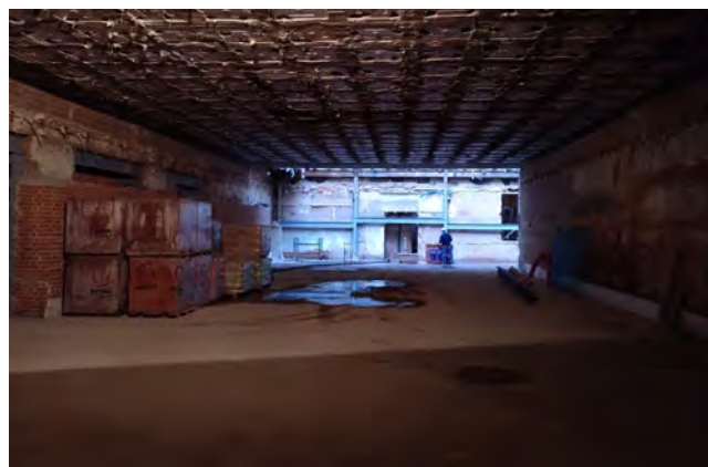
Figura 2. Estado original del forjado reticular.
