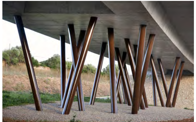
Figura 2. Detalle de la nube de pilas que constituye el apoyo intermedio del paso superior.
