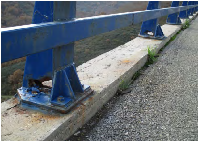
Figura 2. Detalle de los deterioros.
