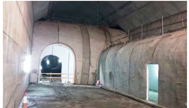
Figura 1. Aspecto de las bóvedas de la GAI del túnel del Espiño, tras el montaje en el interior de la caverna.
