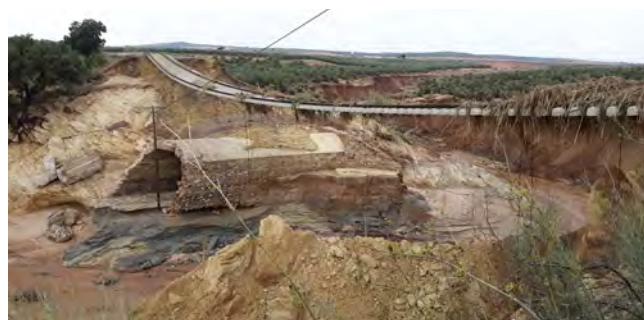
Figura 1. Estado de la vía después del fallo del terraplén.
