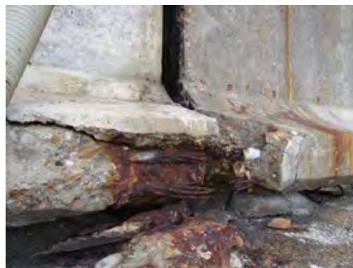
Figura 2. Ejemplo de daños en culata de viga con graves afecciones a la armadura activa y pasiva por corrosión.
