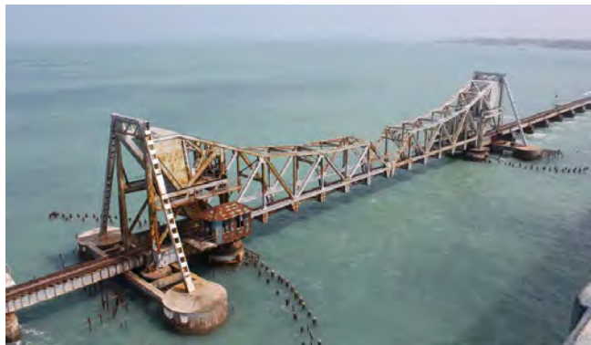
Figura 1. Estado actual del puente de la isla de Pamban.
