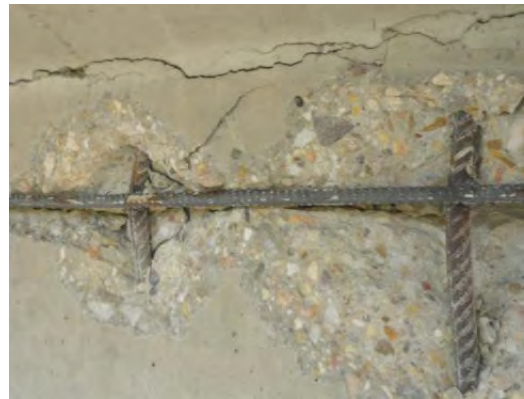
Figura 1. Deformación de cercos y grietas unión alma-ala.
