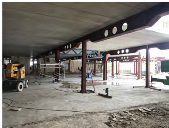
Figura 1. Vista general de la ejecución del nuevo forjado, de estructura mixta formada por placas alveolares y celosías metálicas.
