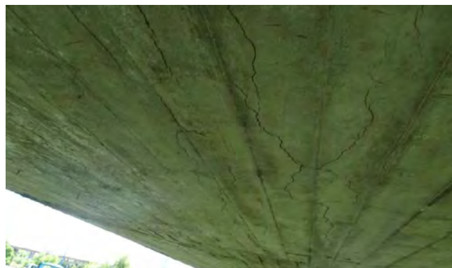
Figura 1. Patologías observadas en las inspecciones llevadas a cabo.
