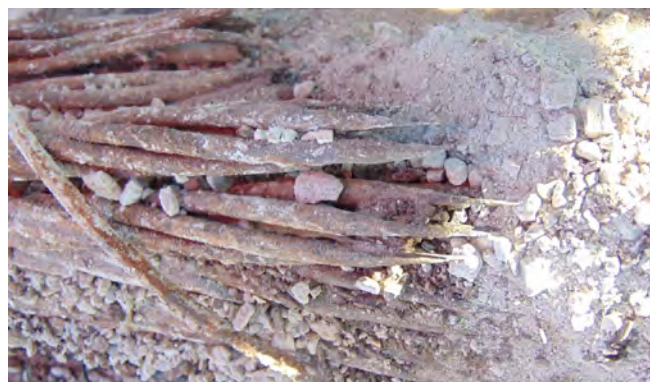
Figura 1. Detalle de cordones en zona de rotura de tirante.
