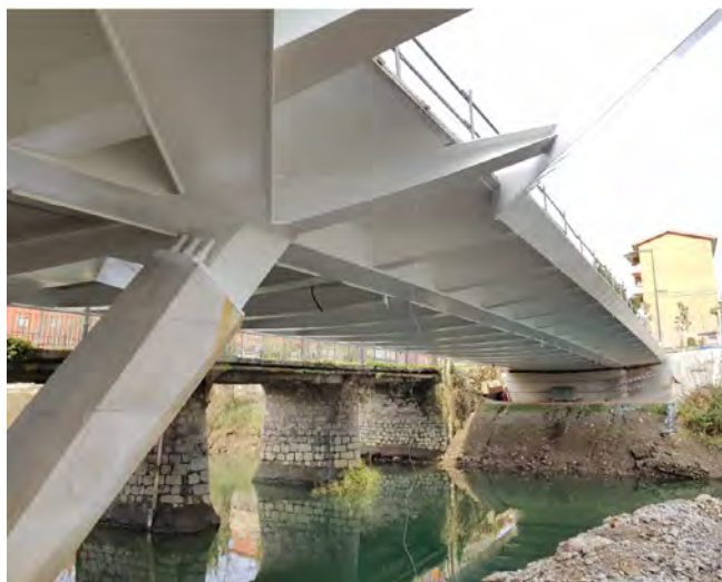
Figura 2. Contrapicado del nuevo puente previo a la demolición del actual Espartxo Zubia.
