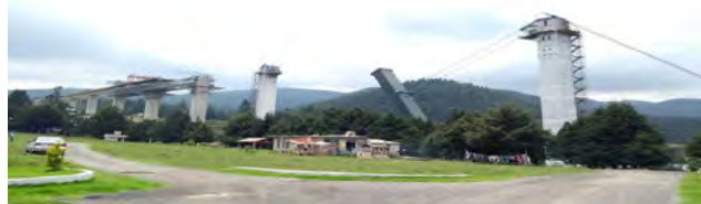
Figura 1. Vista durante el izado de los fustes de la pila en delta.
