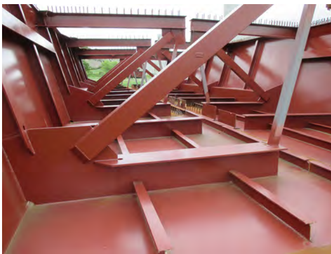
Figura 1. Detalle de encuentros de rigidizadores y diagonal de una celosía en una cartela con detalles mejorados frente a fatiga.
