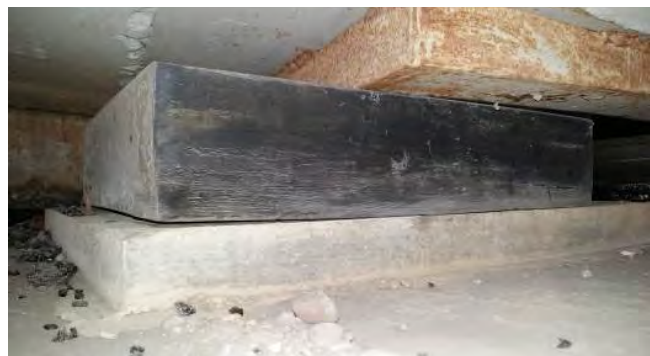
Figura 2. Desplazamiento lateral del tablero respecto de un apoyo de neopreno del estribo E1, que permanecía en su sitio: desplazamiento relativo de 18 cm.
