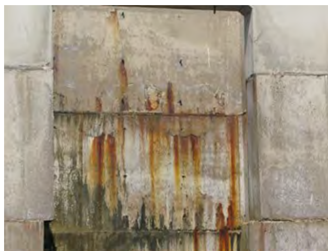
Figura 2. Daños generalizados por corrosión.
