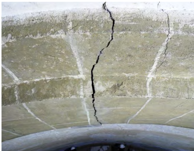
Figura 2. Fisura arco fajón.
