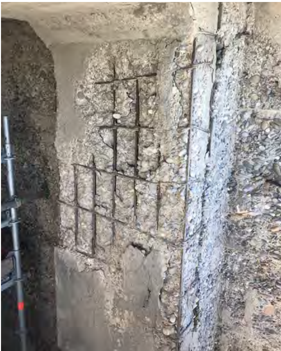
Figura 1. Detalle de montante tipo. Estado inicial completamente degradado y dañado estructuralmente.
