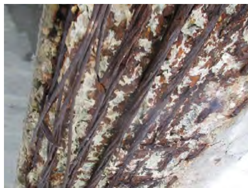
Figura 1. Ejemplo de agotamiento estructural de armadura de pretensado en viga doble "T" por corrosión.
