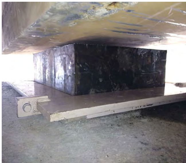
Figura 2. Sistema antirreptación Viaducto A Mó.
