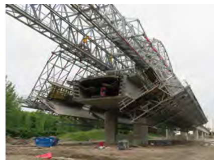
Figura 2. Situación actual de los trabajos. Autocimbra y carro de alas en acción.
