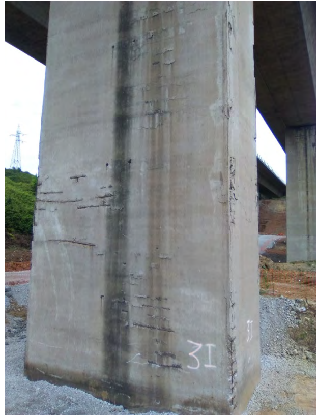
Figura 1. Detalle del deterioro en una pila.
