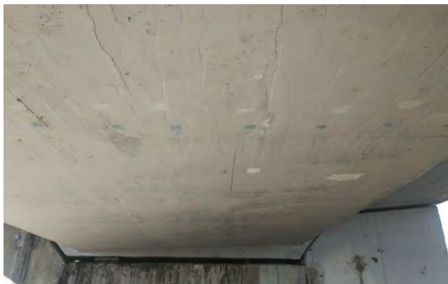
Figura 1. Fisuración consecuencia de los procesos reactivos tipo árido-álcali (cara inferior de la losa).
