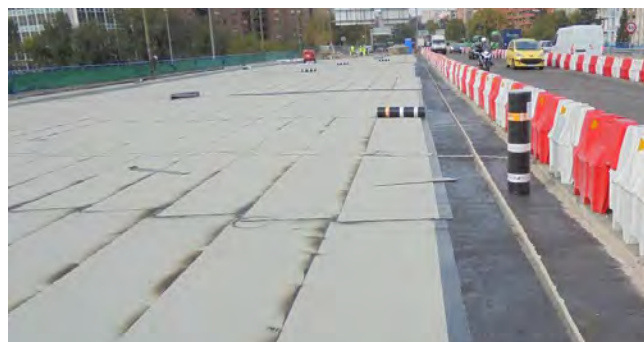
Figura 2. Impermeabilización del tablero mediante lámina asfáltica. (Rehabilitación de los apoyos a media madera del puente de la Avenida del Mediterráneo en Madrid; noviembre de 2017).
