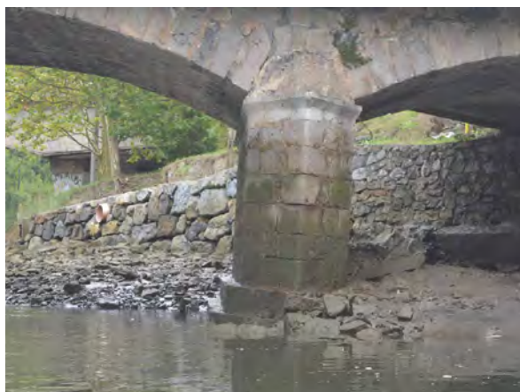
Figura 1. Alzado de pila afectada por asiento y giro de eje transversal.
