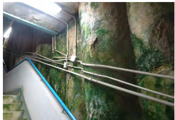
Figura 2. Deterioro acentuado en pantalla de pilotes de salida de emergencia de los túneles de la Calle 30.
