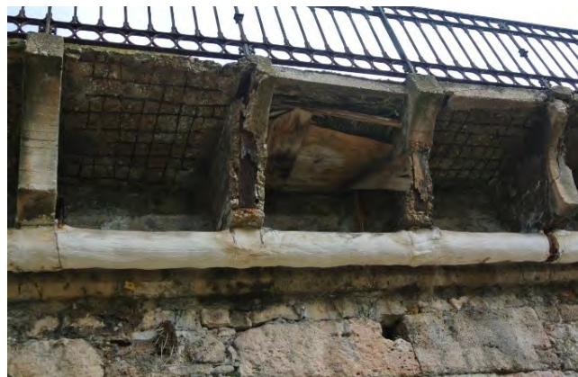
Figura 2. Estado de las costillas de acerado en voladizo y tubería colgada. Obsérvese el mallazo visto del acerado.
