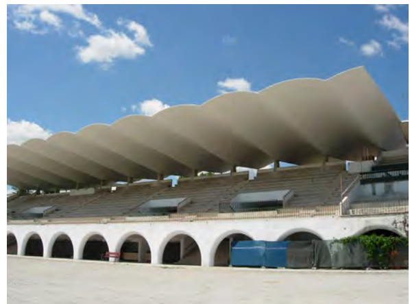
Figura 1. Estado actual de las cubiertas del Hipódromo de la Zarzuela.
