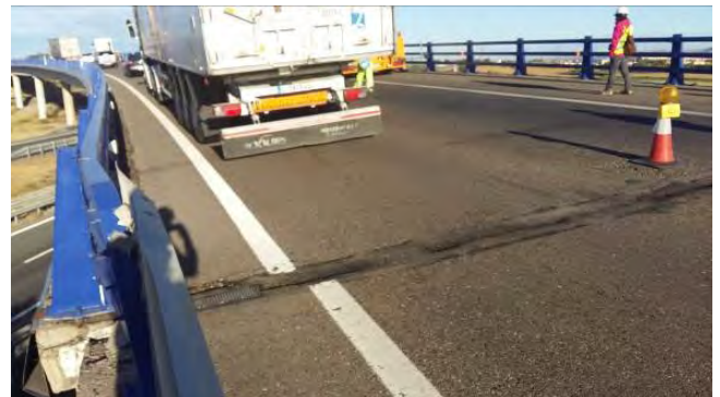
Figura 1. Deslizamiento lateral de 20 cm en el estribo 1.
