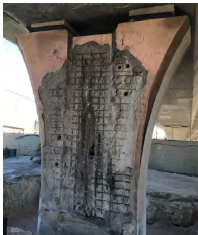
Figura 1. Efecto del incendio sobre la pila 13 del Viaducto de Acceso Sur al Aeropuerto de Málaga.
