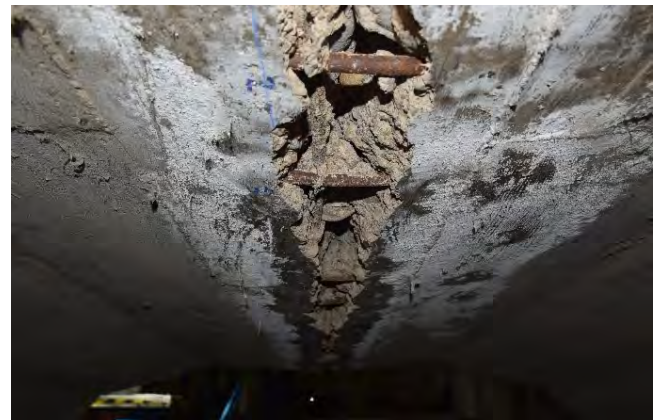
Figura 2. Vista inferior de la pieza 1 al final del ensayo.
