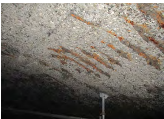
Figura 1. Ataque ácido en bóveda de digestor.
