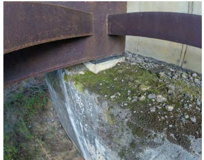
Figura 1. Apoyo dañado Río Deva.
