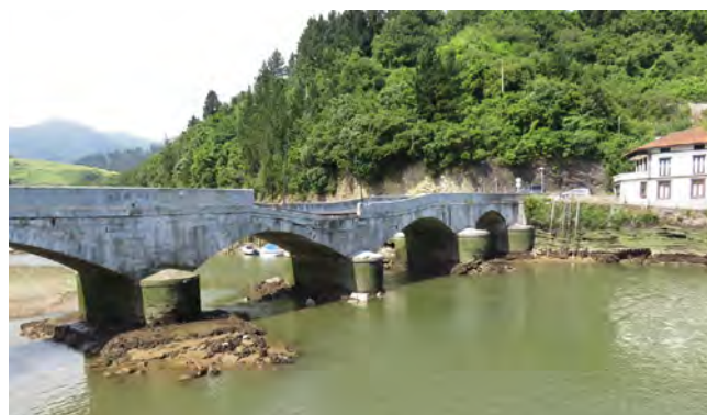
Figura 1. El puente tras el asiento de julio de 2018, visto desde aguas abajo.
