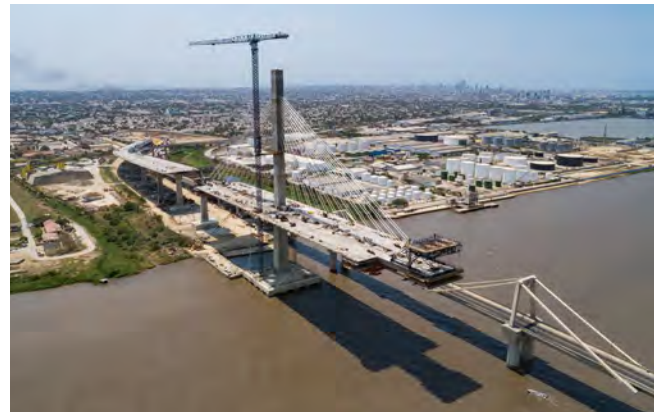
Figura 1. Vista ejecución dovelas con carro de avance superior y carro de alas inferior.
