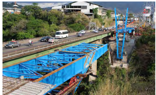
Figura 1. Proceso constructivo del nuevo puente en la RN-147. Inicio de rotación de pila.
