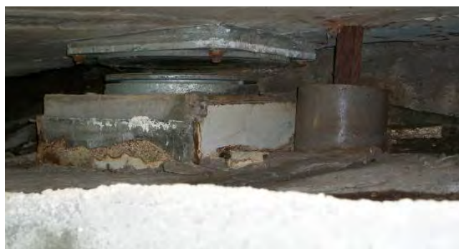
Figura 1. Vista general del viaducto de Silvela y detalle de aparato de apoyo "sin contacto" entre cargadero y tablero.
