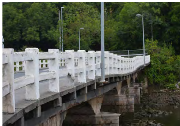
Figura 2. Escorzo del puente con asentamientos reflejados en la barandilla.
