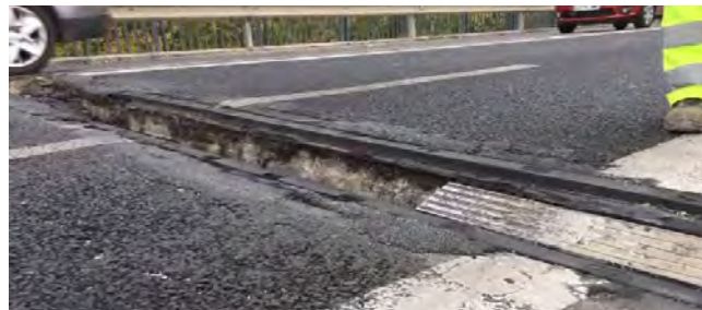
Figura 1. Escalón aparecido en la calzada por levantamiento del vano extremo del Puente de Los Vados (Granada).
