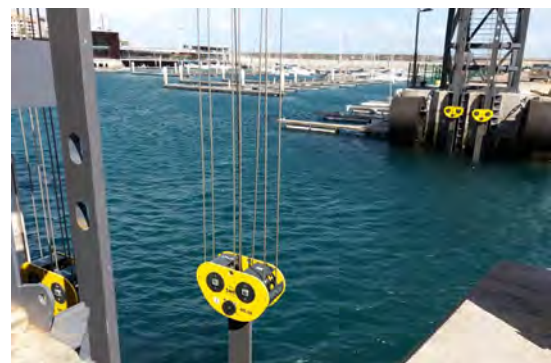
Figura 2. Torres de Cuelgue y Sistema de Elevación de las compuertas.
