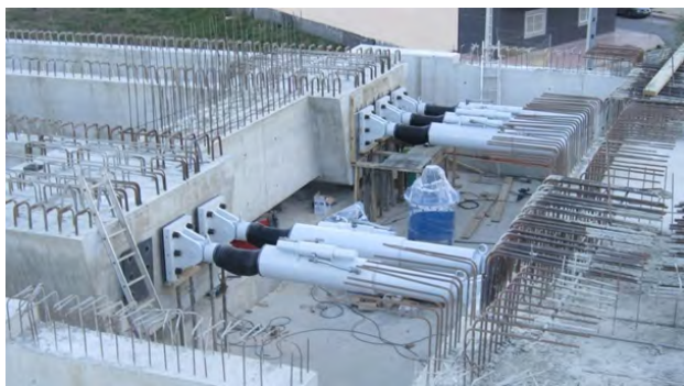
Figura 1. Amortiguadores viscosos en Viaducto de Callosa-Cox.
