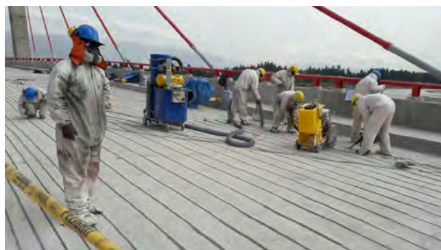
Figura 2. Ejecución de los trabajos de colocación de refuerzos de fibra de carbono.
