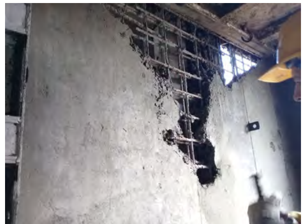
Figura 2. Problemas en el vaciado del concreto.
