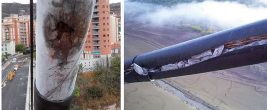
Figura 3. Corrosión en punto de inyección (izquierda) y en interior de vaina fisurada (derecha).
