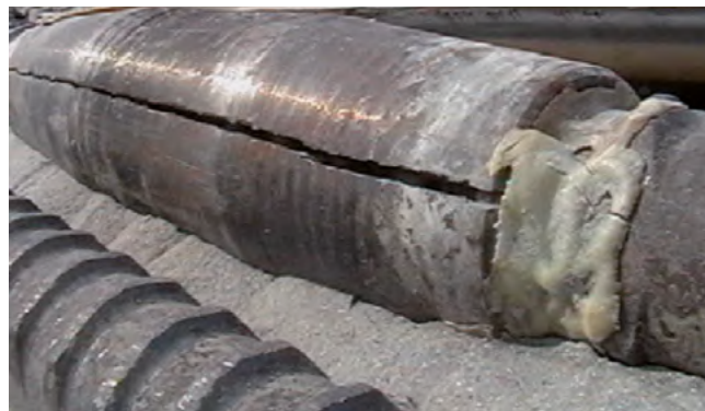
Figura 2. Fisura longitudinal en acoplador de tirante de barras.
