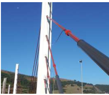
FOTO DE PORTADA: rotura de un cordón en un tirante dotado de brida de seguridad.
