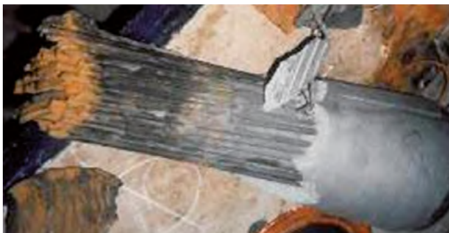
Figura 4. Tirante con hilos paralelos roto a proximidad del anclaje inferior.
