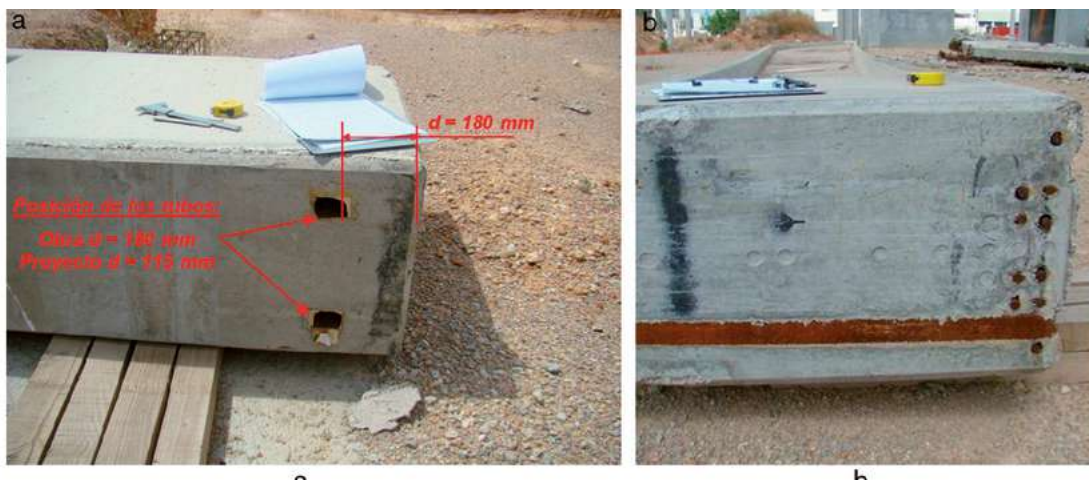
Figura 7. Problemas de montaje en apoyos de soporte recto.
