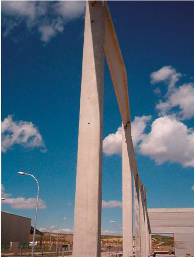
Figura 11. Vuelco en «vigas delta».
