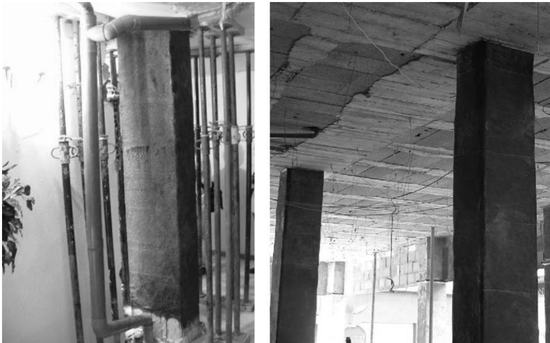
Figura 7. Pilares sin tratamiento del soporte (refuerzos ejecutados tras el sismo en Lorca).
