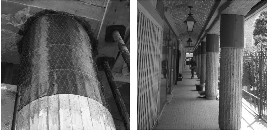
Figura 6. Pilares sin tratamiento del soporte (refuerzos ejecutados tras el sismo en Lorca).
