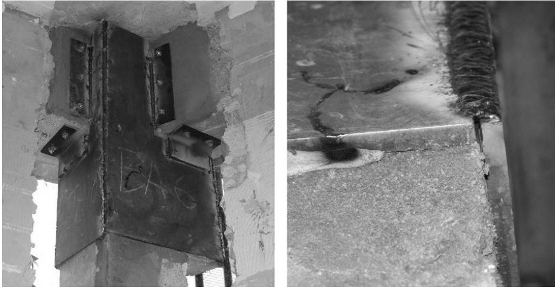
Figura 8. Detalles incorrectos en zunchado de pilares (refuerzos ejecutados tras el sismo en Lorca).
