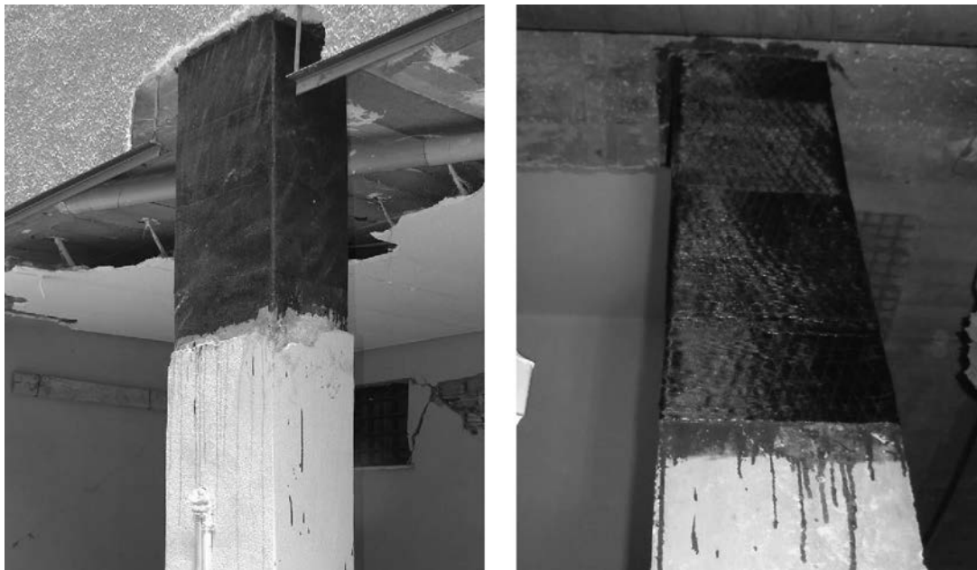
Figura 9. Refuerzos en los que no se respetan las indicaciones en relación con el tratamiento de la superficie y redondeo de esquinas (refuerzos ejecutados tras el sismo en Lorca).
