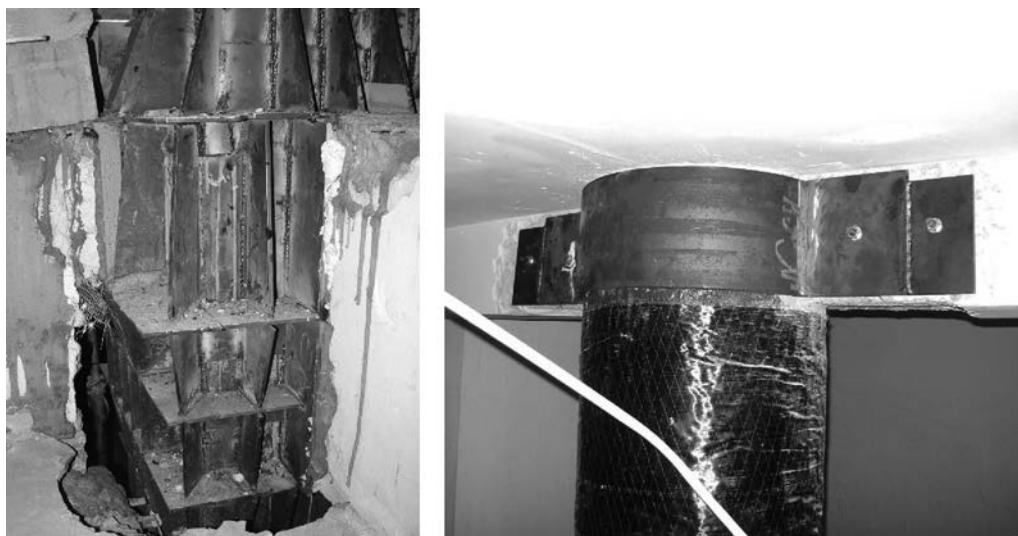
Figura 2. Ejemplos de actuaciones en nudos para encamisado y zunchado de pilares (fotos tomadas en Lorca).
