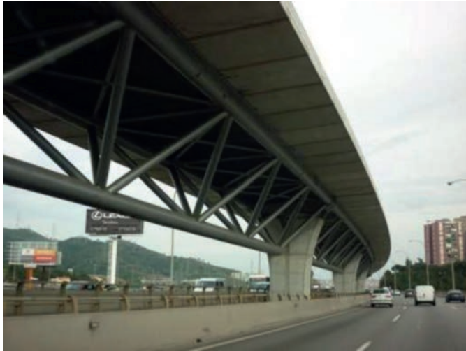
Figura 1. Vista del tablero.
