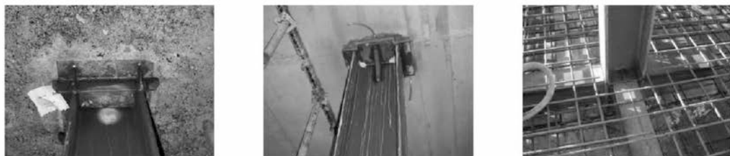
Figura 7. Detalle de punzonamiento mediante crucetas con base en ACI 318-99. Fotos cortesía de D. Rafael Fortézar. DRAGADOS.
