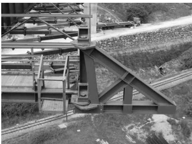
Figura 14. Detalle de la puertas ubicadas en la nariz de lanzamiento
