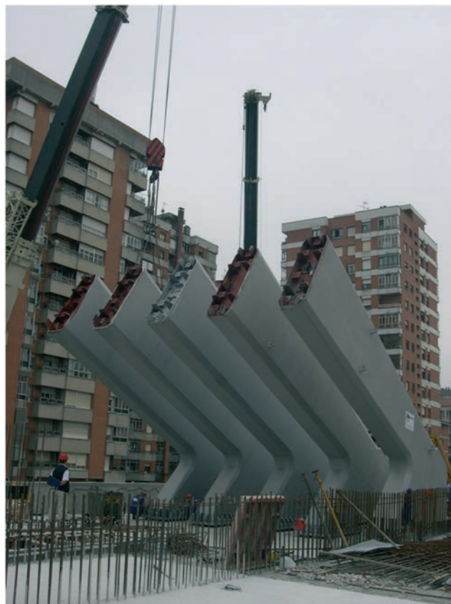
Figura 34. Bases de los pórticos principales ya anclados a la estructura de hormigón
