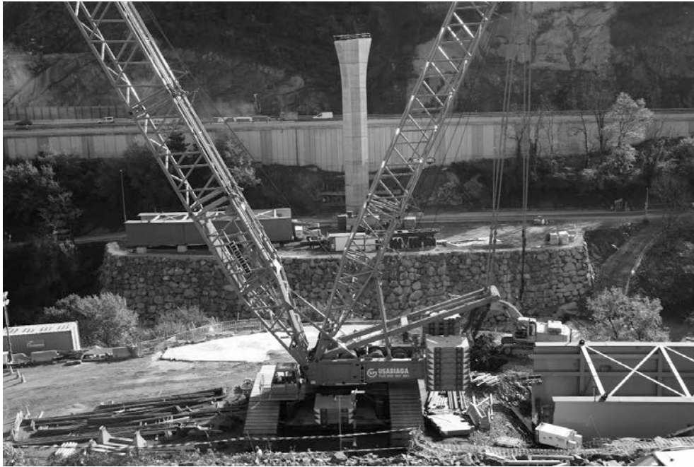
Figura 37. Vista en primer plano de la Plataforma 1 y la grúa de izado, al fondo la Plataforma 2
