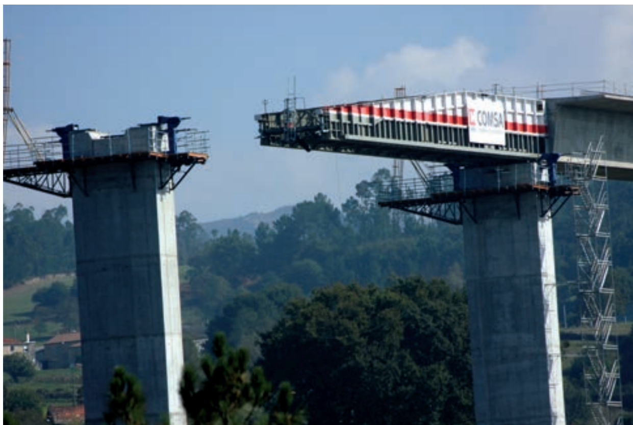
Figura 23. Empuje del viaducto sobre Río Deza
