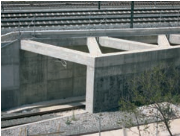
Figura 8. Vista parcial de la pérgola en la L.A.V. Córdoba-Málaga en Málaga
