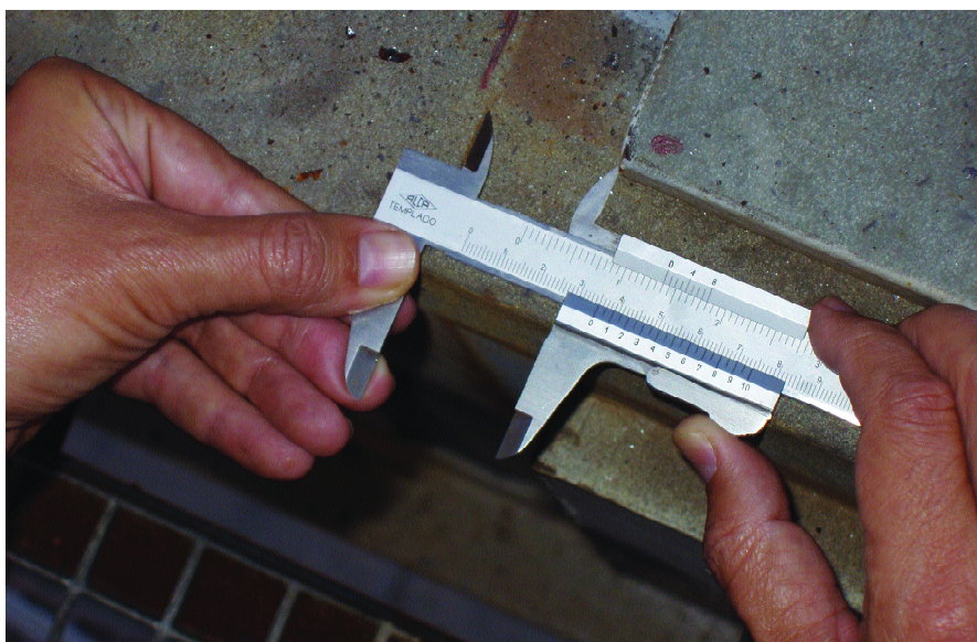
Figura 23. Deslizamiento de unión 2-3. Figure 23. Sliding of union 2-3-
