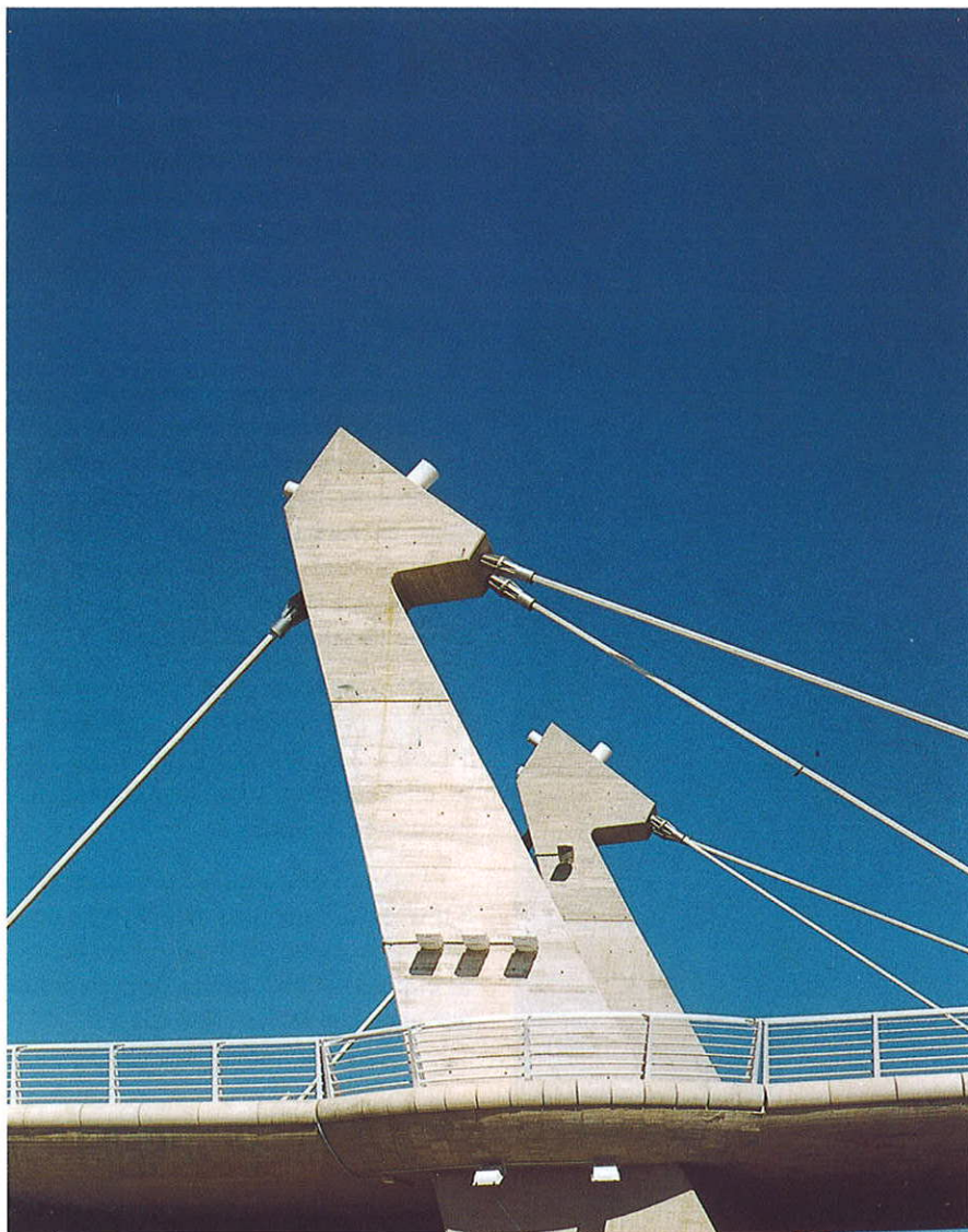
Figura 12. Vista de los fustes de una pila. Figure 12. View of Piers shaft.
