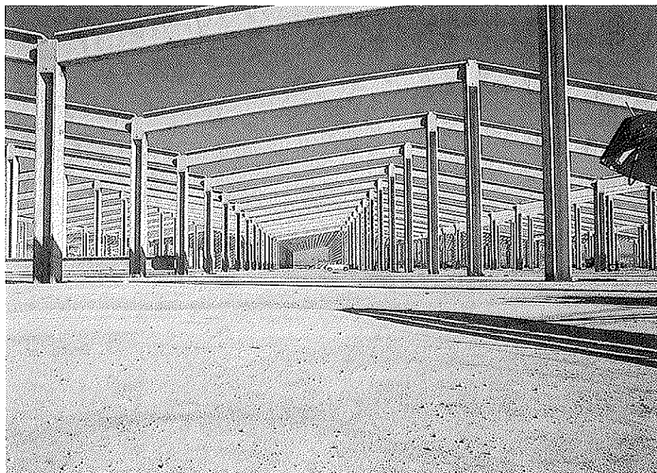
Fig. 8. Sistema elemental de pilares y jácenas, prefabricado por PACADAR.
