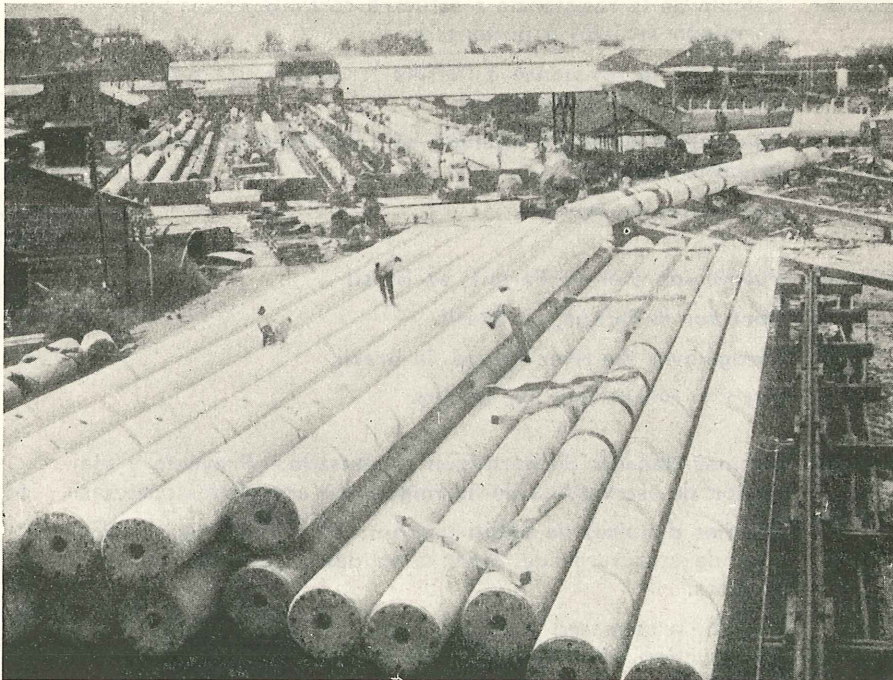
Fig. 14.—Pilotaje de un puente en North Klang Straits, Malaya. Se necesitaron para este puente 1.500 pilotes de hormigón pretensado, de 45,5 m de longitud cada uno. Los pilotes tienen un diámetro exterior de 87,5 centímetros y paredes de 11,6 cm de espesor (película F. I. P.).
