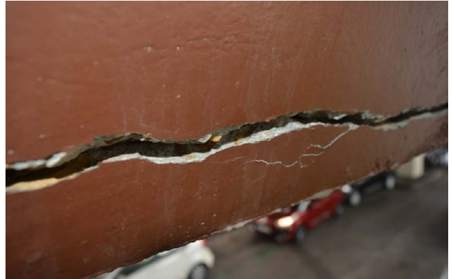
Figura 13. Grieta en vano 6 (suroeste de la estructura). Foto de los autores, 12 de febrero de 2020.
