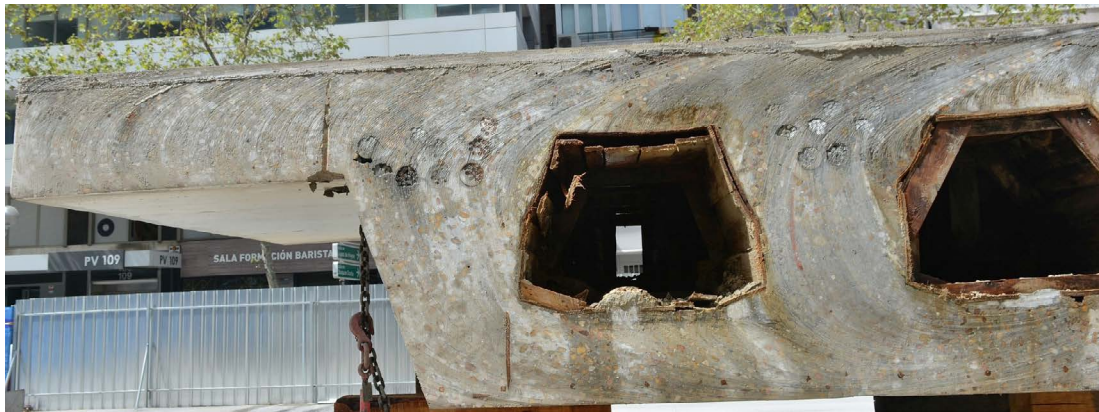
Figura 8. Sección de una de las dovelas cortadas, en el proceso de desmontaje, en las proximidades de un apoyo. La altura de los alvéolos es de apenas 0.55 m (el canto total de la sección, constante, es de 1.20 m, con una esbeltez de L/28.15 ) (foto de los autores).
