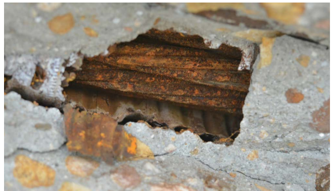
Figura 15. Tendón sin lechada en lado oeste del vano 6 (entre P-5 y P-6), en la calicata en la zona de la figura 13 . Foto de los autores, 12.02.2020.
