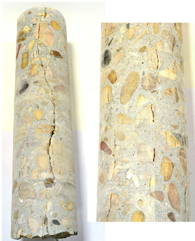
Figura 23. Fisuras longitudinales en testigos resultado de las perforaciones verticales a posteriori para el enhebrado del hilo de diamante durante el proceso de demolición. Foto cortesía del Laboratorio de Química de la Escuela de Ingenieros de Caminos, C. y P. de Madrid, no incluida en [11].
