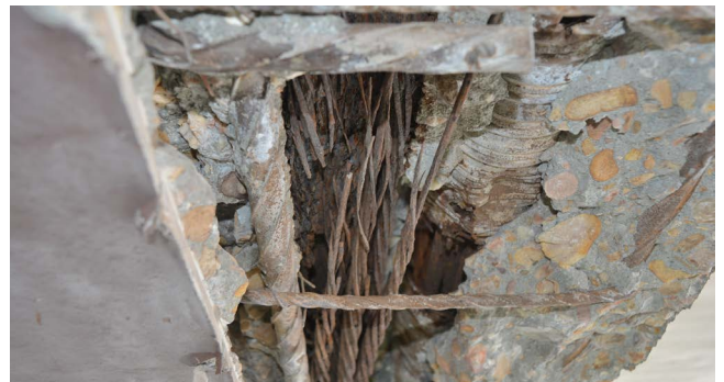
Figura 14. Tendón roto, sin lechada, detectado tras practicar una calicata en la zona de la figura 13 . Foto de los autores.
