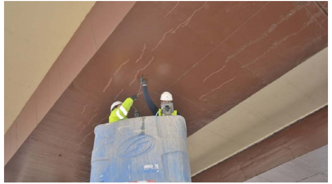
Figura 12. Fisuras longitudinales selladas en losa de fondo (foto de los autores, marzo de 2020).
