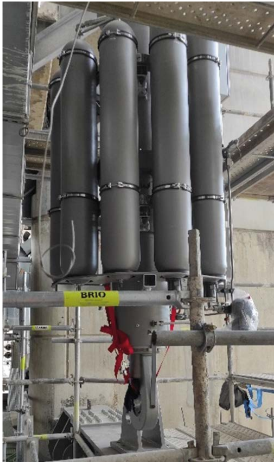
Figura 59. Vista del sistema.
