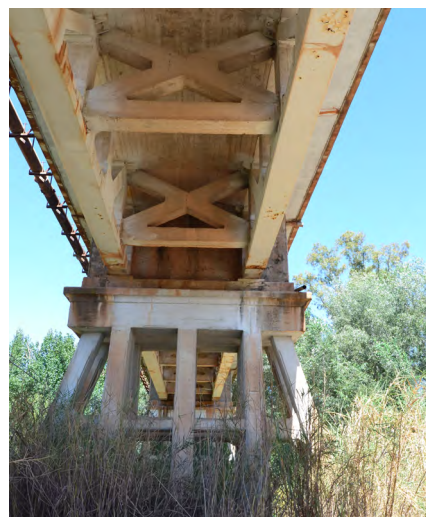
Figura 18. Arriostramientos transversales en cruz de San Andrés, incorporados con posterioridad a la ejecución de las vigas principales a instancias del ingeniero López Molero. Foto del autor.
