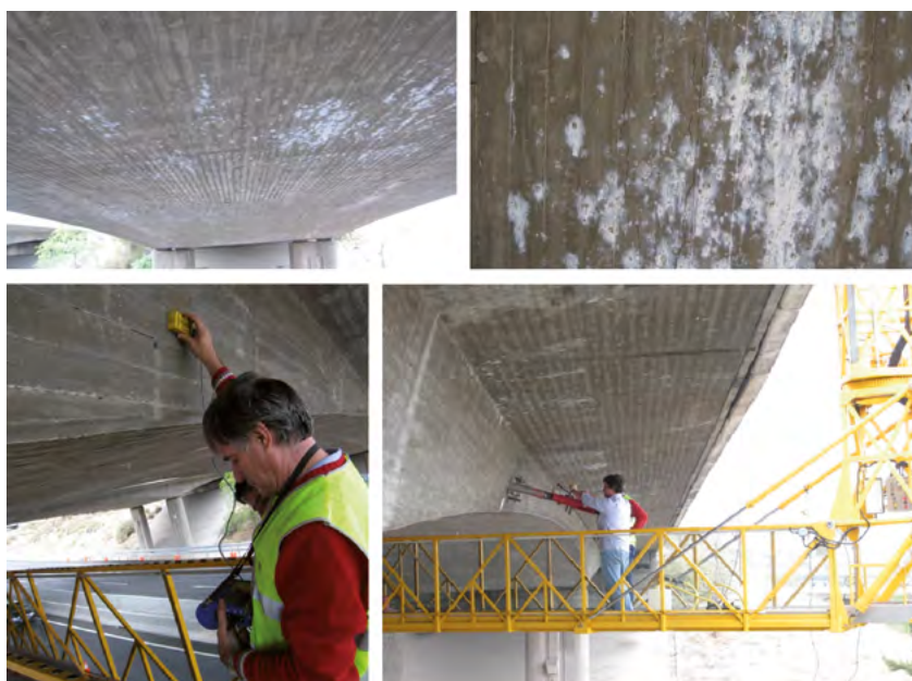
Figura 19. Estudio de un puente de hormigón postesado afectado por un ataque árido-álcali (2009).
