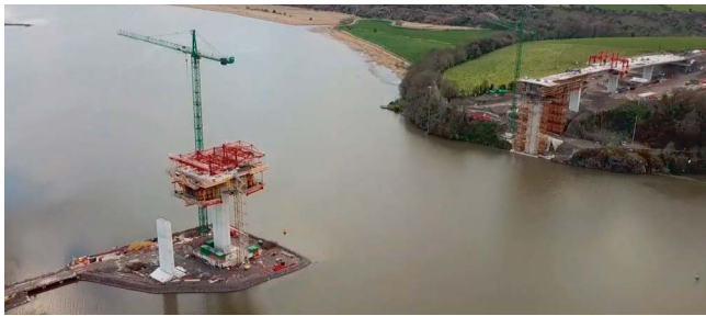
Figura 1. Cruce del río durante la construcción (P4 central -derecha- y P3 lateral -izquierda-).
