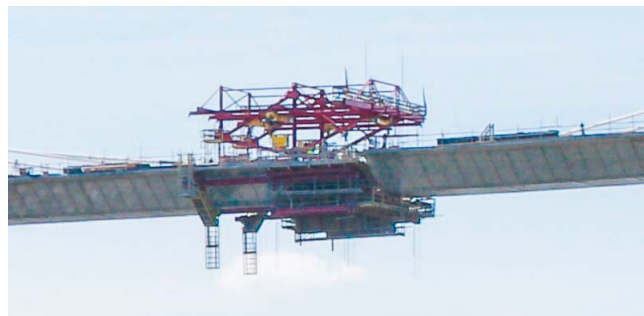
Figura 21. Flecha diferencial en voladizo de vano 4.
