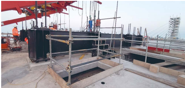
Figura 23. Alzado del puente durante el hormigonado de la última dovela de la pila 4.
