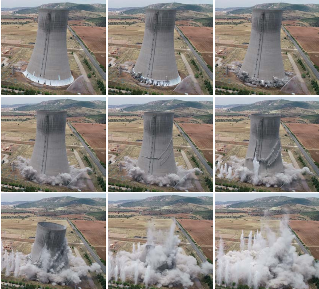
Figura 16. Fotografías del proceso de caída de la Torre de Refrigeración.
