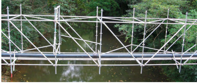
Figura 18. Detalle celosía tubular para el paso de tubería de abastecimiento.
