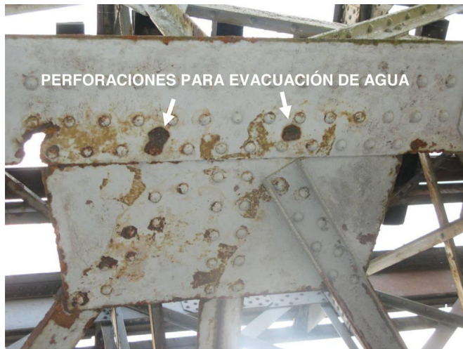
Figura 9. Hendiduras por corrosión en un patín inferior.
